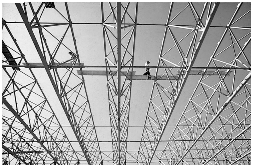
FIG. 28. FOTOGRAFÍA DEL PROCESO DE CONSTRUCCIÓN DONDE SE APRECIA LA SEPARACIÓN ENTRE PÓRTICOS Y EL ANCHO DE ESTOS
