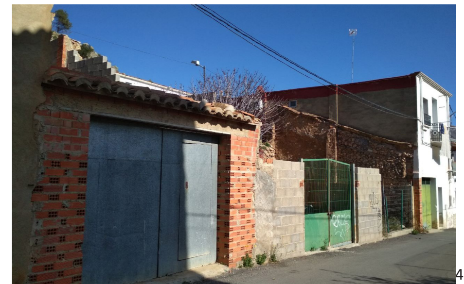
Figura 61. Muro de mampostería bajo la línea de suelo. Pajar P-2. Fuente: Visita de campo. Febrero 2020.
