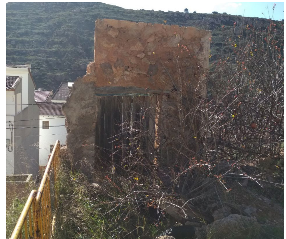
Figura 65. Vista del muro de mampostería y el pilar. Pajar P-3. Fuente: Visita de campo. Febrero 2020.
