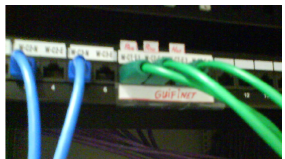
Figura 3.21. Fotografía cableado hasta armario red
