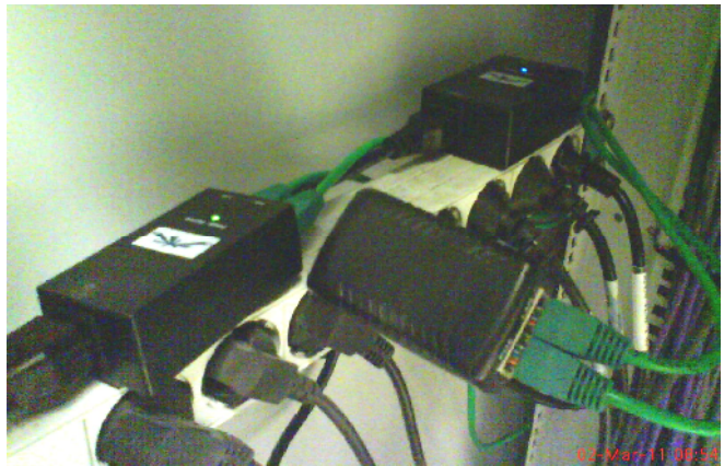
Figura 3.29. Fotografía de los inyectores POE en el armario
