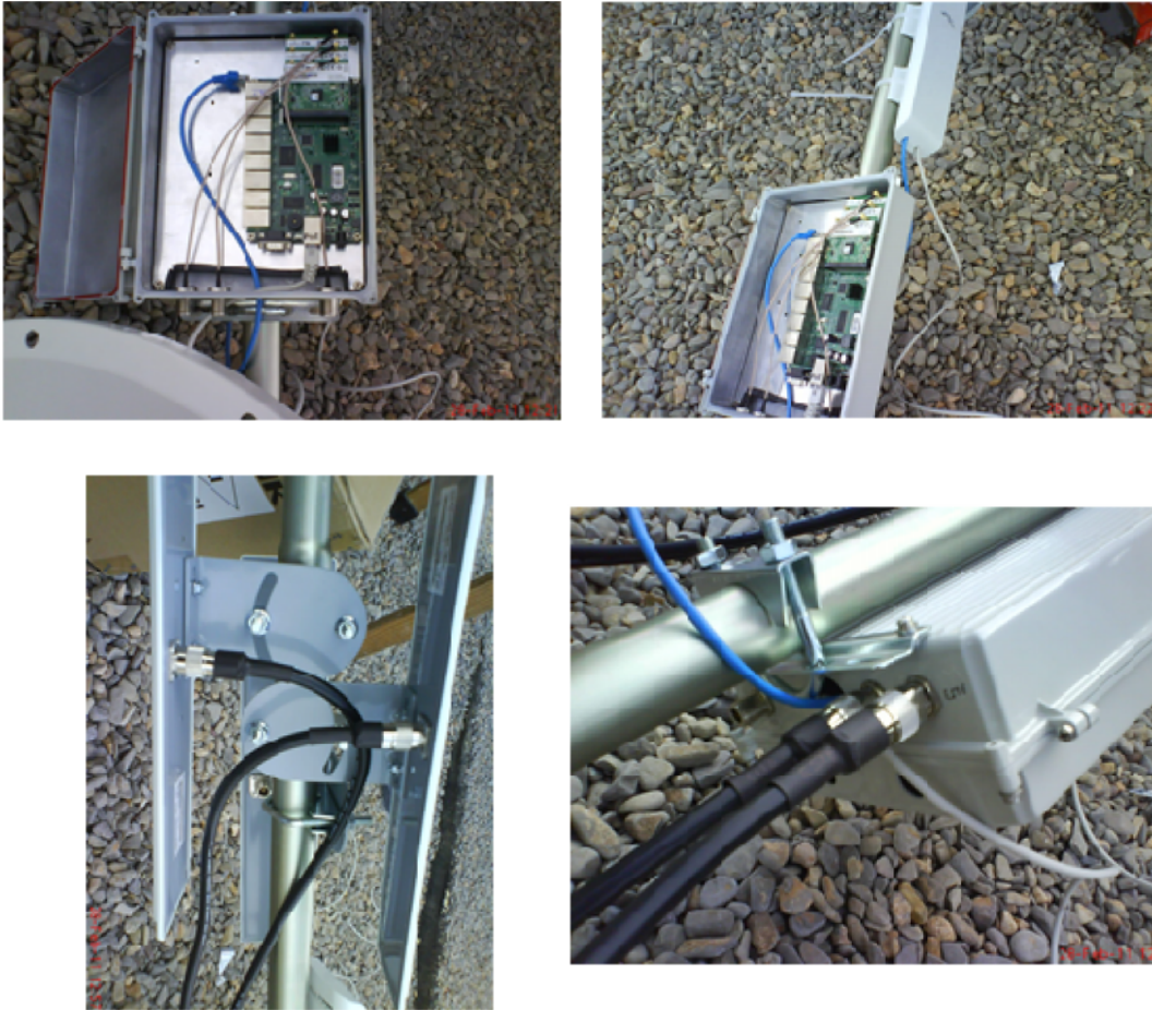
Figura 3.25. Fotografías del cableado entre antenas y router
