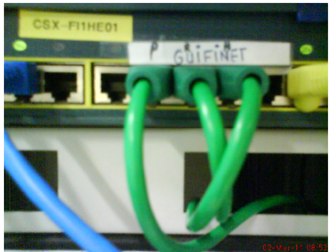
Figura 3.31. Fotografía de las conexiones en el switch
