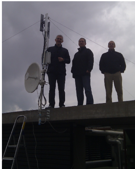
Figura 3.33. Fotografía de la instalación final con los que intervinieron en ella.
