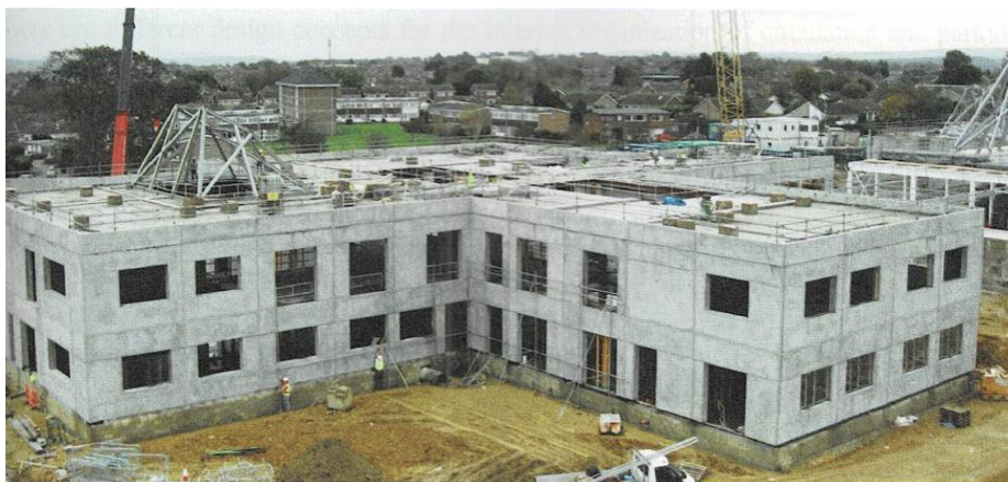
Imagen 11: Sistema de Paneles (Coves School)
