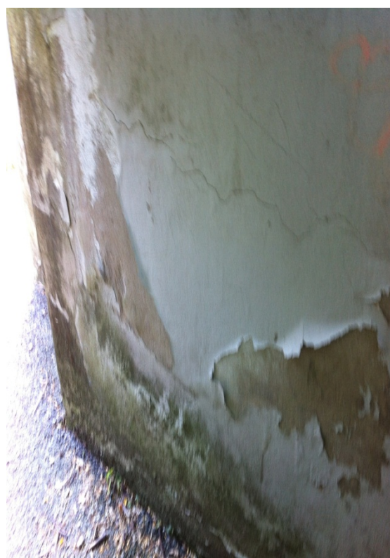
3.6 Umidità, patina biologica, distacco dell'intonaco.
