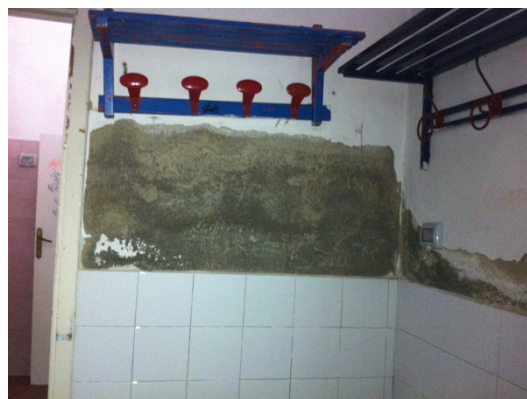
12 Spogliatoio. Umidità e distacco dell'intonaco.
