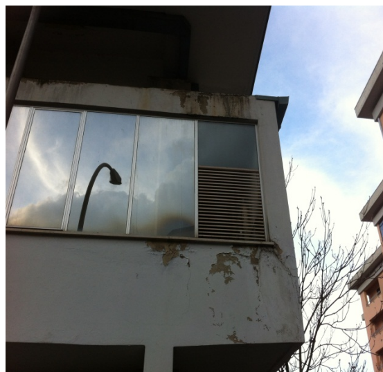
1.4 Umidità, degrado dell'intonaco e fessurazione.
