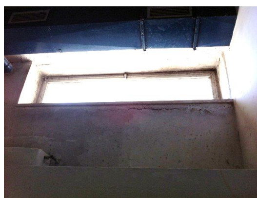
14 Bagno. Fessurazione orizzontale sotto la finestra e umidità di condensa.
