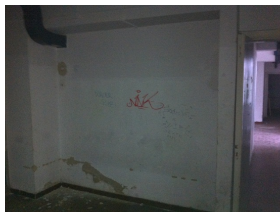
35 Spogliatoio. Umidità, distacco dell'intonaco e murales di vernice indelebile.
