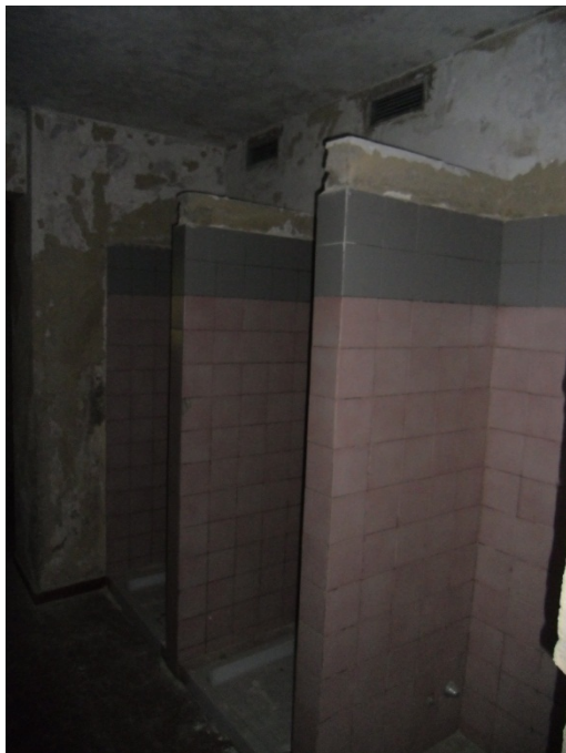
24 Bagno. Umidità da risalita capillare e di condensa, degrado e distacco dell'intonaco.
