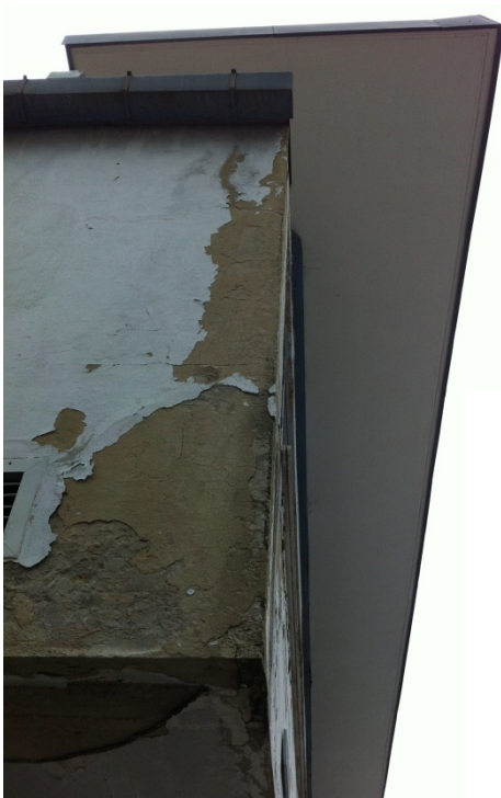
3.1 Umidità, degrado e distacco dell'intonaco
