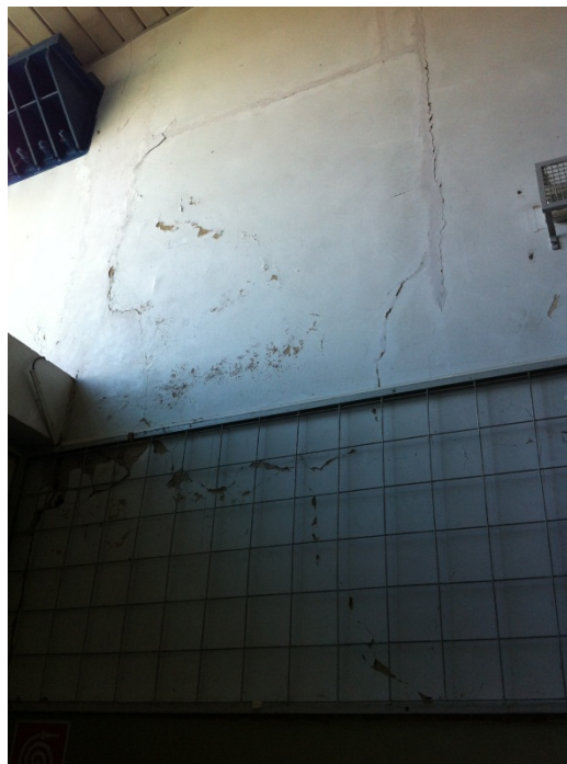
45 Campo di gioco. Fessurazione orizzontale e verticale della tamponatura, distacco dell'intonaco.
