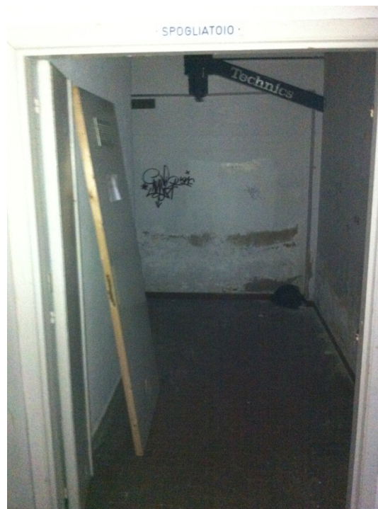
34 Spogliatoio. Umidità da risalita capillare, degrado e distacco dell'intonaco e murales di vernice indelebile.
