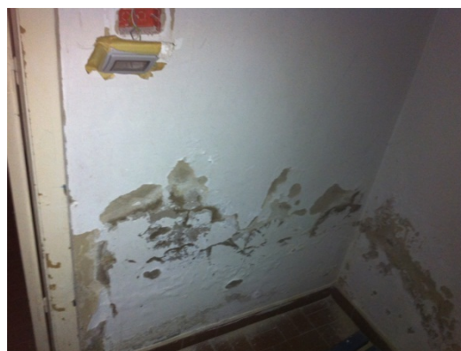
8 Spogliatoio. Umidità da risalita capillare e distacco dell'intonaco.
