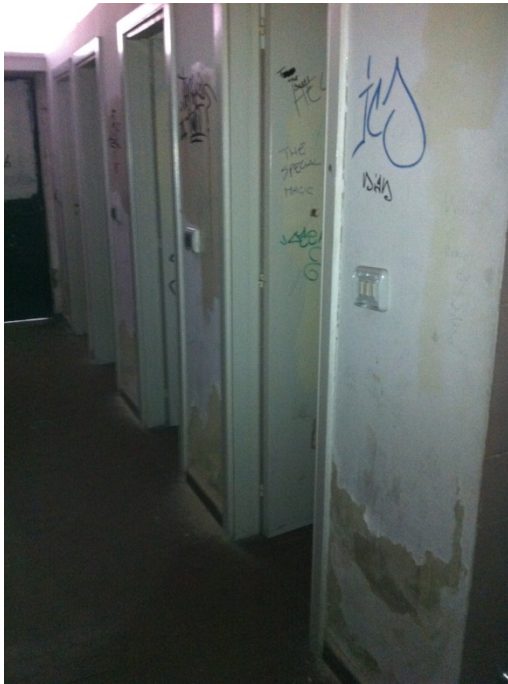
40 Bagno. Umidità da risalita capillare, degrado e distacco dell'intonaco, murales in vernice indelebile.
