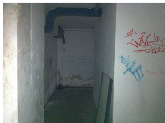
31 Spogliatoio. Murales in vernice indelebile, umidità degrado e distacco dell'intonaco.
