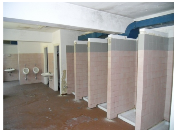
51 Bagno. Umidità di condensa, patina biologica, distacco dell'intonaco.
