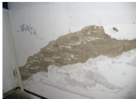
37 Spogliatoio. Umidità da risalita capillare, degrado e distacco dell'intonaco.
