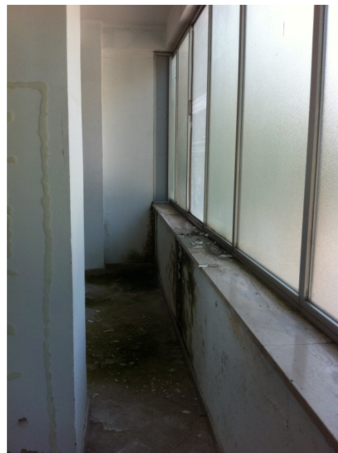
49 Sala di boxe. Umidità, patina biologica degrado e distacco dell'intonaco.
