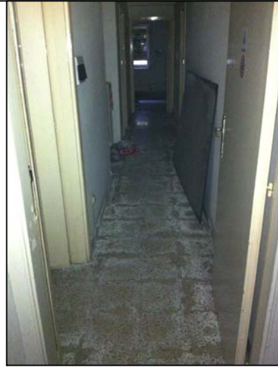
Efflorescenza sul pavimento.
