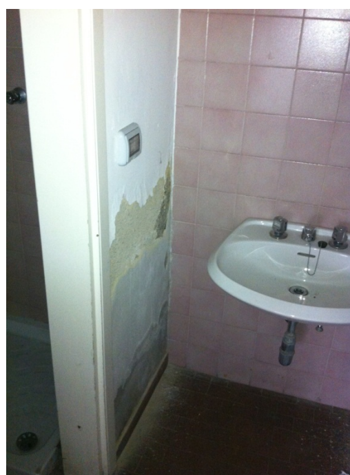
16 Bagno. Umidità da risalita capillare e distacco dell'intonaco.
