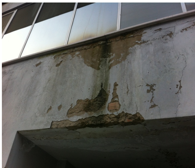
1.3 Fessurazione, patina biologica, umidità e distacco dell'intonaco.
