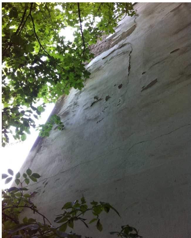
3.5 Distacco dell'intonaco, fessurazione orizzontale e verticale.
