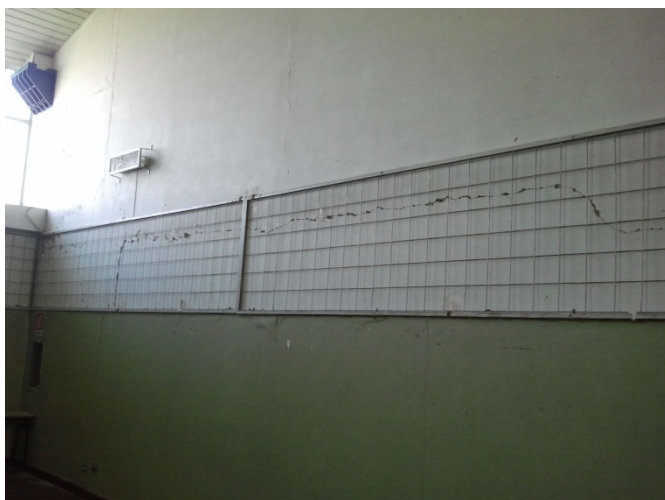
44 Campo di gioco. Fessurazione orizzontale della tamponatura.
