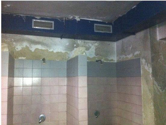
26 Bagno. Umidità da risalita capillare e di condensa, degrado e distacco dell'intonaco.
