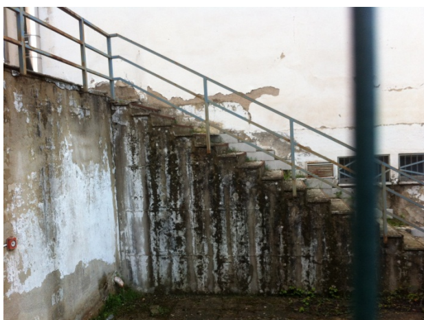
2.9 Umidità, distacco dell'intonaco, patina biologica, efflorescenza nel calcestruzzo, vegetazione.
