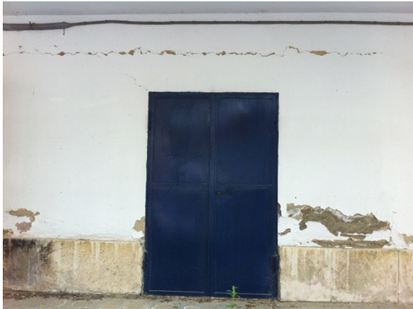
2.5 Degrado e distacco dell'intonaco, fessurazione orizzontale e umidità
