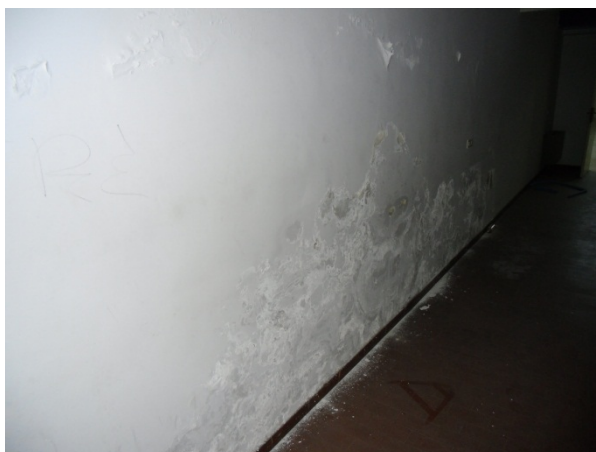
52 Corridoio. Umidità e distacco dell'intonaco.
