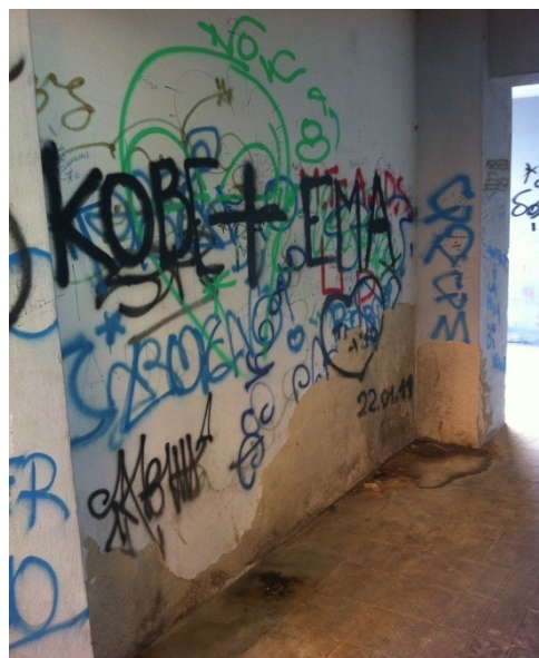
1.6 Distacco dell'intonaco, murales in vernice indelebile
