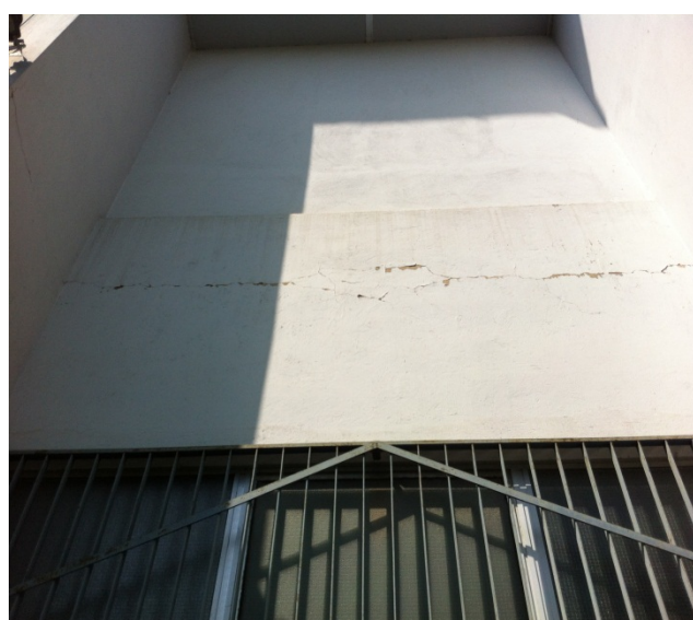
4.5 Fessurazione orizzontale tra la struttura e il muro.
