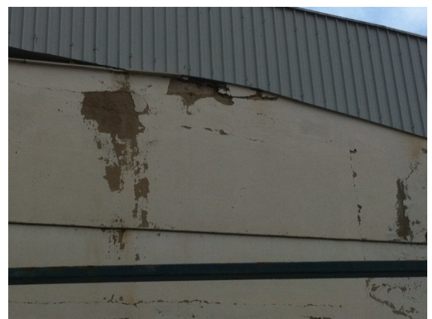
2.10 Distacco dell'intonaco e fessurazione orizzontale.
