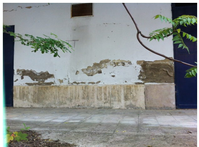
2.4 Distacco dell'intonaco, umidità e patina biologica.
