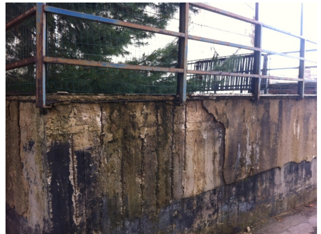
2.8 Degrado del ferro, disgregazione del calcestruzzo, distacco dell'intonaco e umidità
