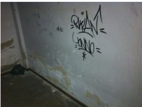
33 Spogliatoio. Umidità da risalita capillare, degrado e distacco dell'intonaco e murales di vernice indelebile.
