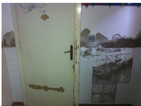
13 Spogliatoio. Distacco dell'intonaco e smottamento delle piastrelle a causa dell'umidità da risalita capillare.
