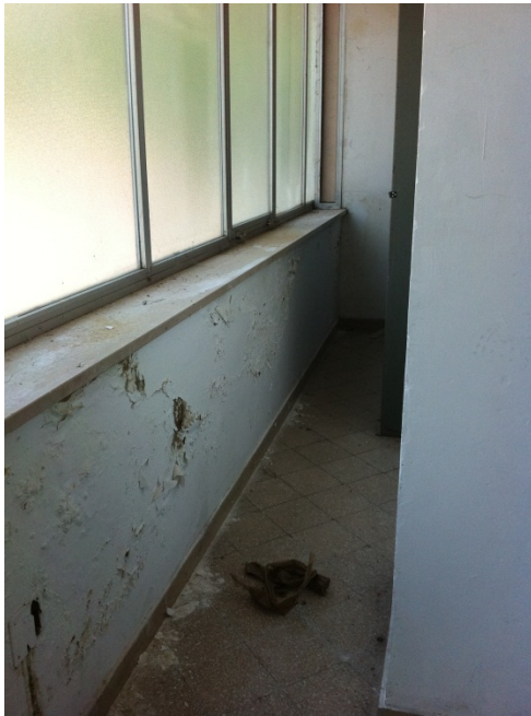
48 Sala di boxe. Umidità, degrado e distacco dell'intonaco.
