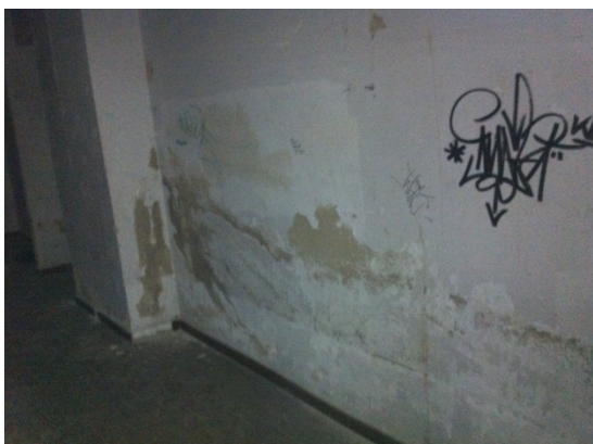
32 Spogliatoio. Umidità da risalita capillare, degrado e distacco dell'intonaco e murales di vernice indelebile.
