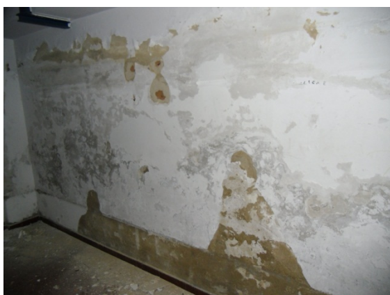
36 Spogliatoio. Umidità da risalita capillare, degrado e distacco dell'intonaco.
