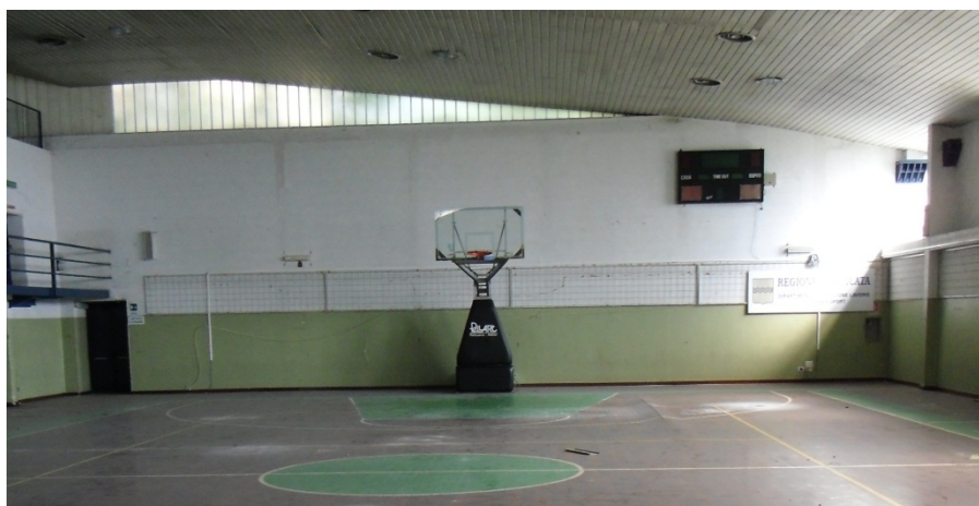
47 Campo di gioco. Fessurazione orizzontale della tamponatura.
