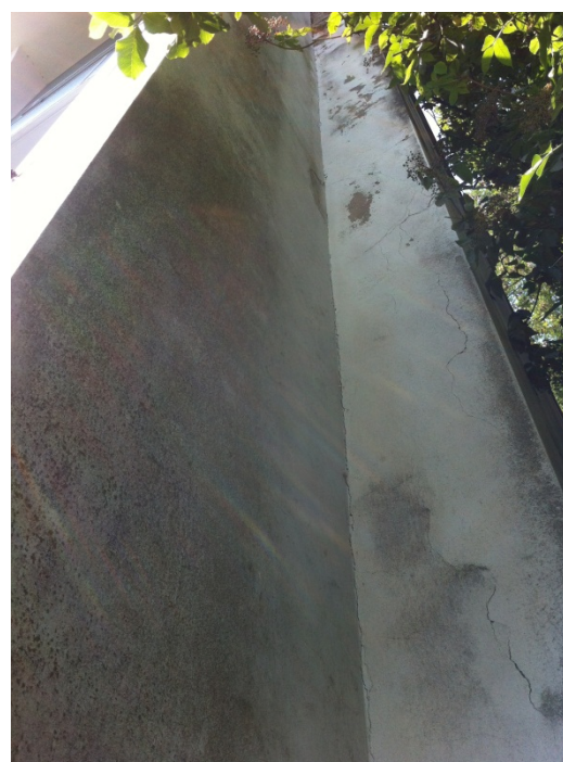
4.6 Degrado dell'intonaco, umidità, patina biologica e fessurazione verticale.
