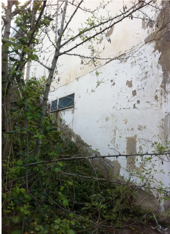
2.11 Vegetazione, umidità, degrado e distacco dell'intonaco
