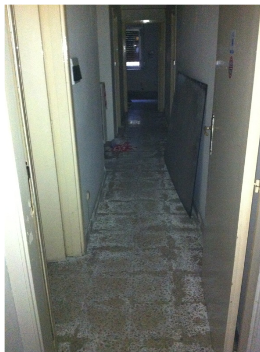
21 Corridoio. Efflorescenze sul pavimento.
