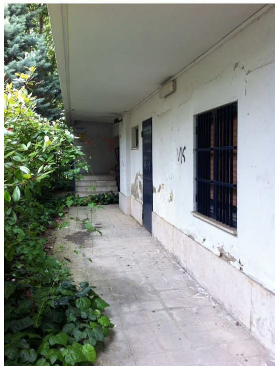
3.2 Fessurazione orizzontale, degrado dell'intonaco, vegetazione, umidità e efflorescenza sul pavimento.
