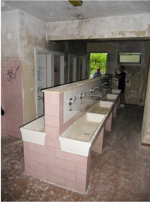
22 Bagno. Umidità da risalita capillare e di condensa, degrado e distacco dell'intonaco.
