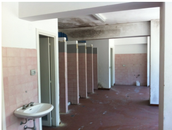
50 Bagno. Umidità di condensa, distacco dell'intonaco.
