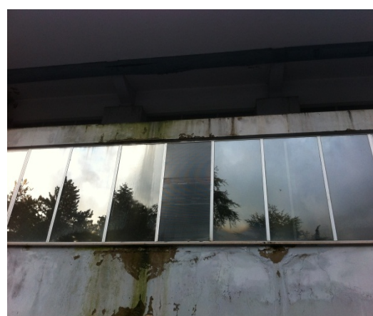
1.2 Rottura di grondaia, umidità diffusa, patina biologica e fessurazione
