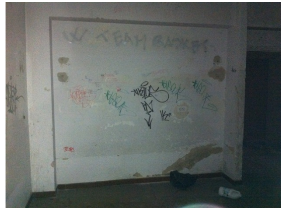
29 Spogliatoio. Umidità, distacco dell'intonaco, murales in vernice indelebile.
