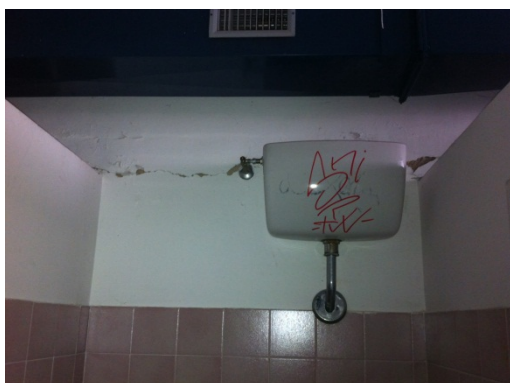
42 Bagno. Fessurazione orizzontale.
