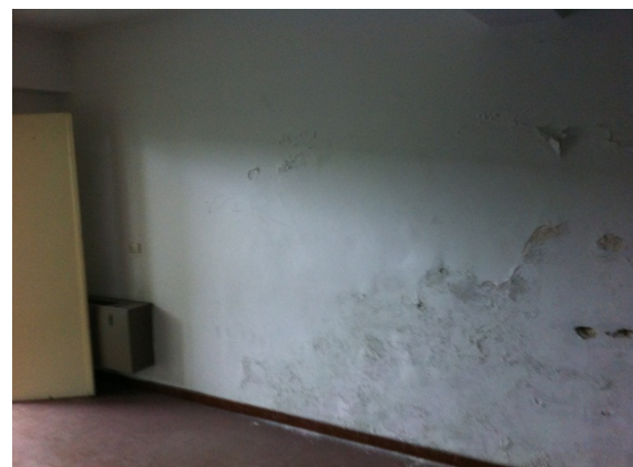
53 Corridoio. Umidità e distacco dell'intonaco.
