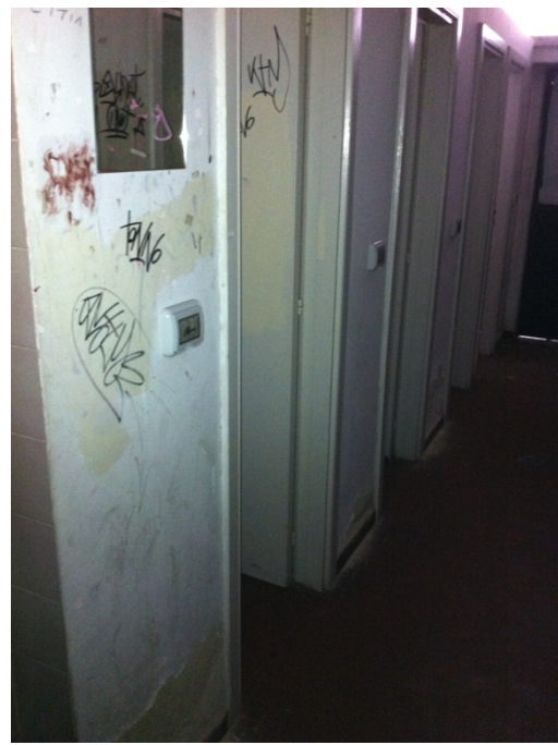
41 Bagno. Umidità da risalita capillare, degrado e distacco dell'intonaco, murales in vernice indelebile.
