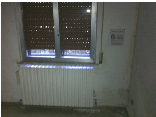
17 Camera. Umidità da risalita capillare, degrado dell'intonaco, efflorescenza sul pavimento.
