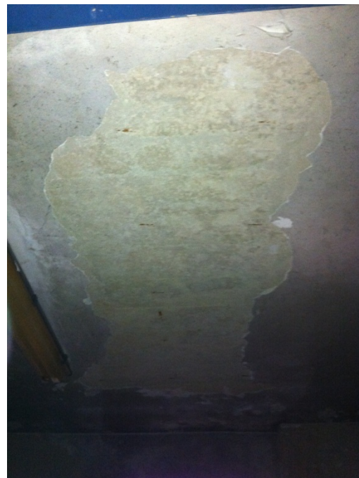
25 Bagno. Umidità di condensa, distacco dell'intonaco.
