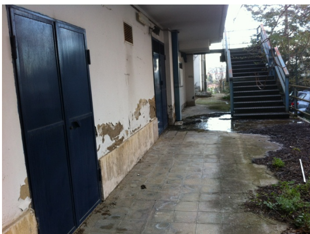
2.3 Distacco dell'intonaco e umidità, patina biologica e vegetazione sul pavimento
