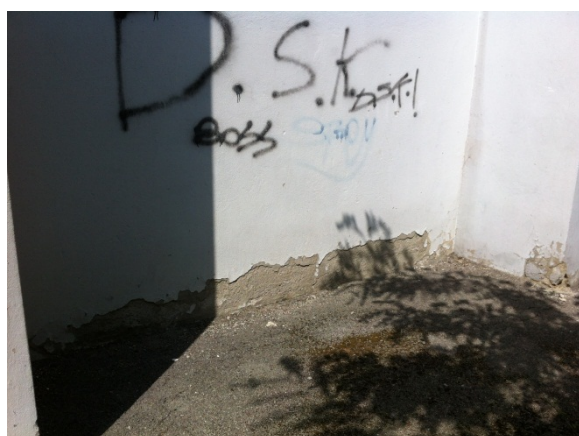
4.4 Murales in vernice indelebibile, umidità e distacco dell'intonaco
