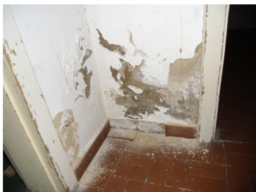
9 Spogliatoio. Umidità da risalita capillare e distacco dell'intonaco.
