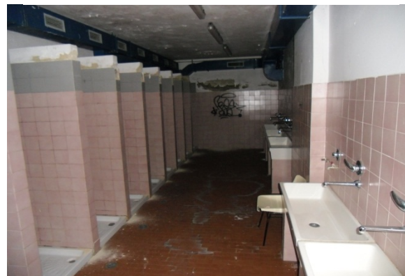
43 Bagno. Umidità sul pavimento e umidità di condensa, degrado e distacco dell'intonaco.
