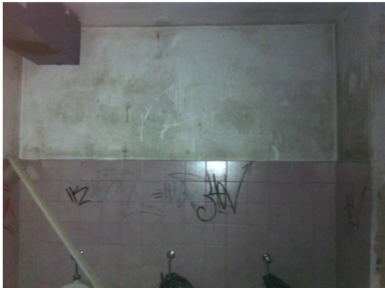
28 Bagno. Macchie di umidità da risalita capillare, murales in vernice indelebile.
