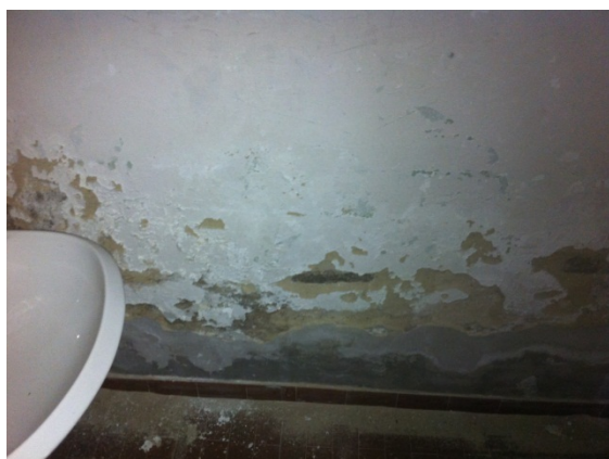
15 Bagno. Umidità da risalita capillare e distacco dell'intonaco.
