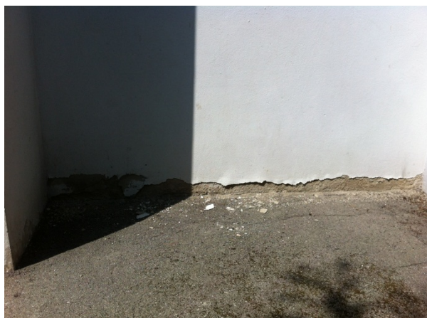
4.3 Umidità e distacco dell'intonaco
