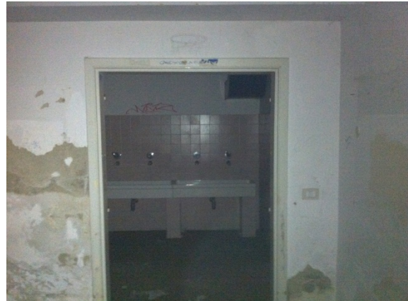
39 Spogliatoio. Umidità da risalita capillare, degrado e distacco dell'intonaco.
