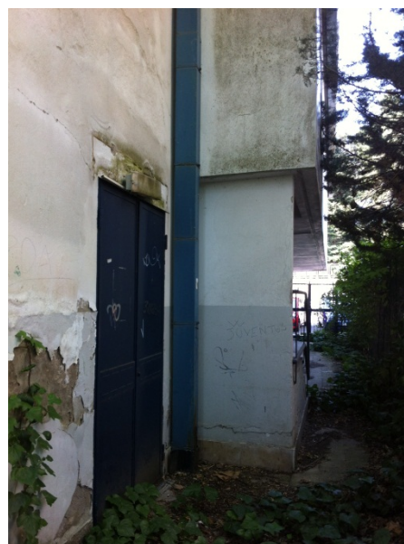
3.4 Vegetazione, distacco dell'intonaco, fessurazione orizzontale, umidità e patina biologica.
