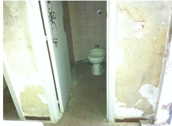
27 Bagno. Umidità da risalita capillare, distacco dell'intonaco.
