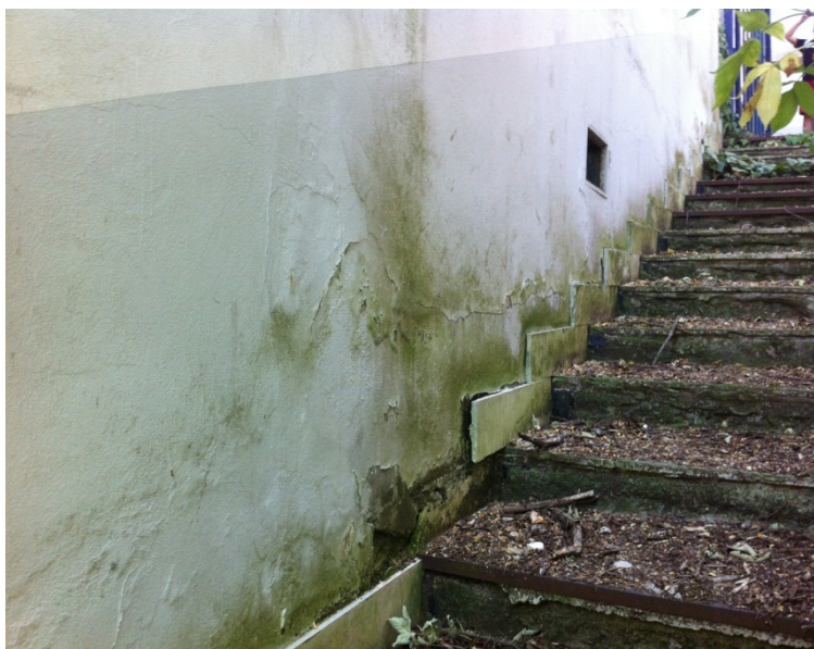
3.3 Umidità, patina biologica e degrado dell'intonaco.
