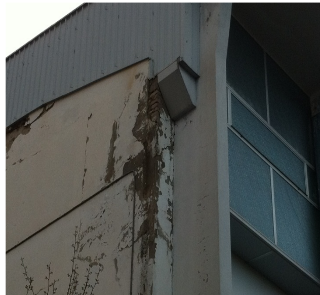
2.14 Distacco dell'intonaco e fessurazione verticale.
