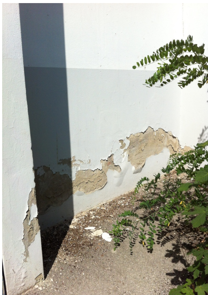
4.5 Umidità e distacco dell'intonaco
