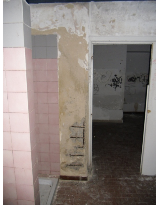
23 Bagno. Umidità da risalita capillare, degrado del ferro, disgregazione del copriferro, distacco dell'intonaco.
