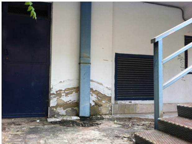
2.7 Umidità, degrado dell'intonaco e patina biologica
