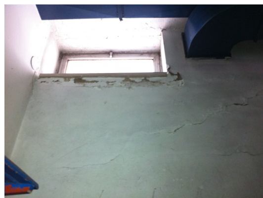
10 Spogliatoio. Umidità, distacco dell'intonaco e fessure inclinate.
