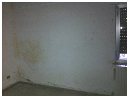
18 Camera. Umidità da risalita capillare, macchia di umidità, degrado dell'intonaco.
