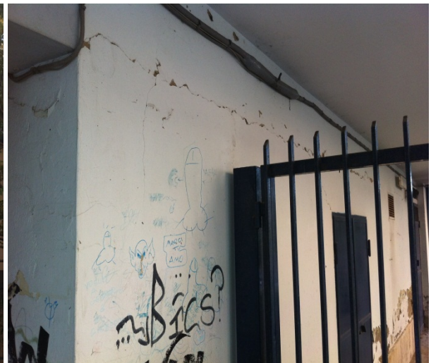
2.2 Fessurazione orizzontale e murales in vernice indelebile
