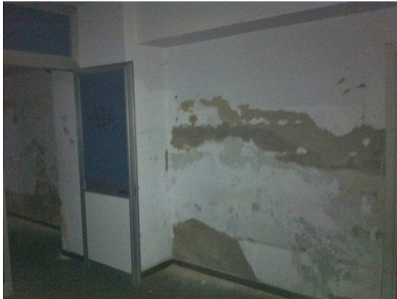
38 Spogliatoio. Umidità da risalita capillare, degrado e distacco dell'intonaco.
