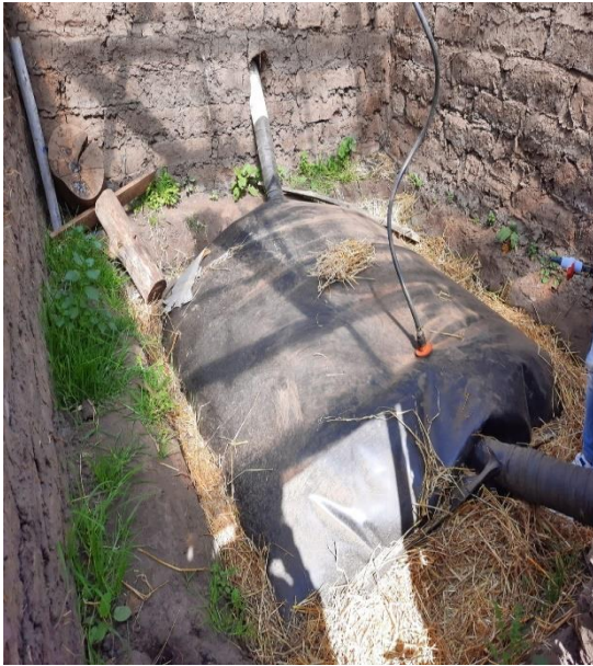
Figura 39. Biodigestor en el interior de la caseta con su salida de gas.
