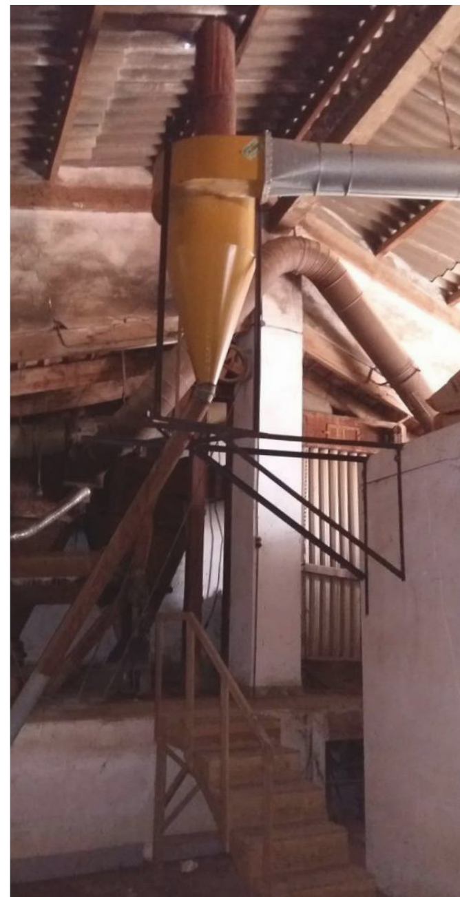
Figura 3.2.2: Maquinaria original del edificio
