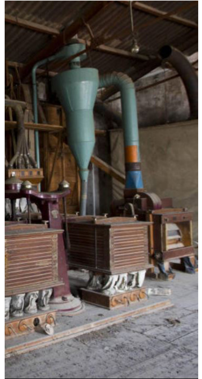
Figura 3.2.4: Maquinaria original del edificio
