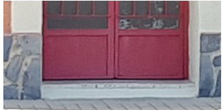
Deformaciones de las carpinterías metálicas en la estación de Crevillente. Foto de autor
