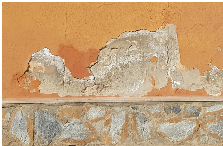
Desprendimientos de enlucidos en la estación de Callosa de Segura.
