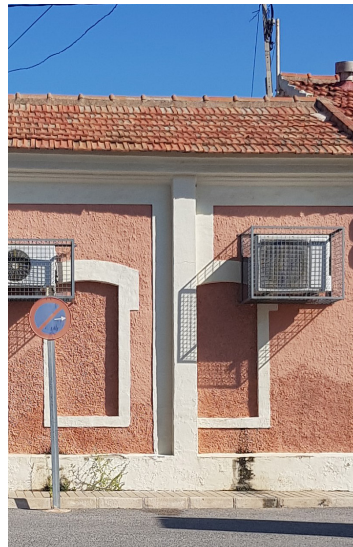
Humedad en la estación de Torrellano.
