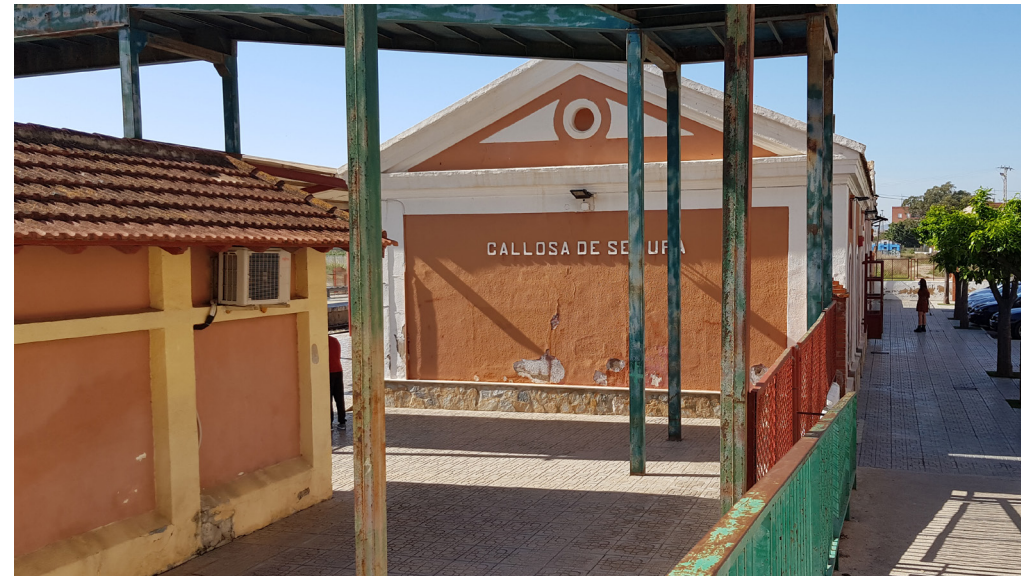
Desconchados y cuarteados del revestimiento en una de las fachadas de Callosa de Segura. Foto de autor
