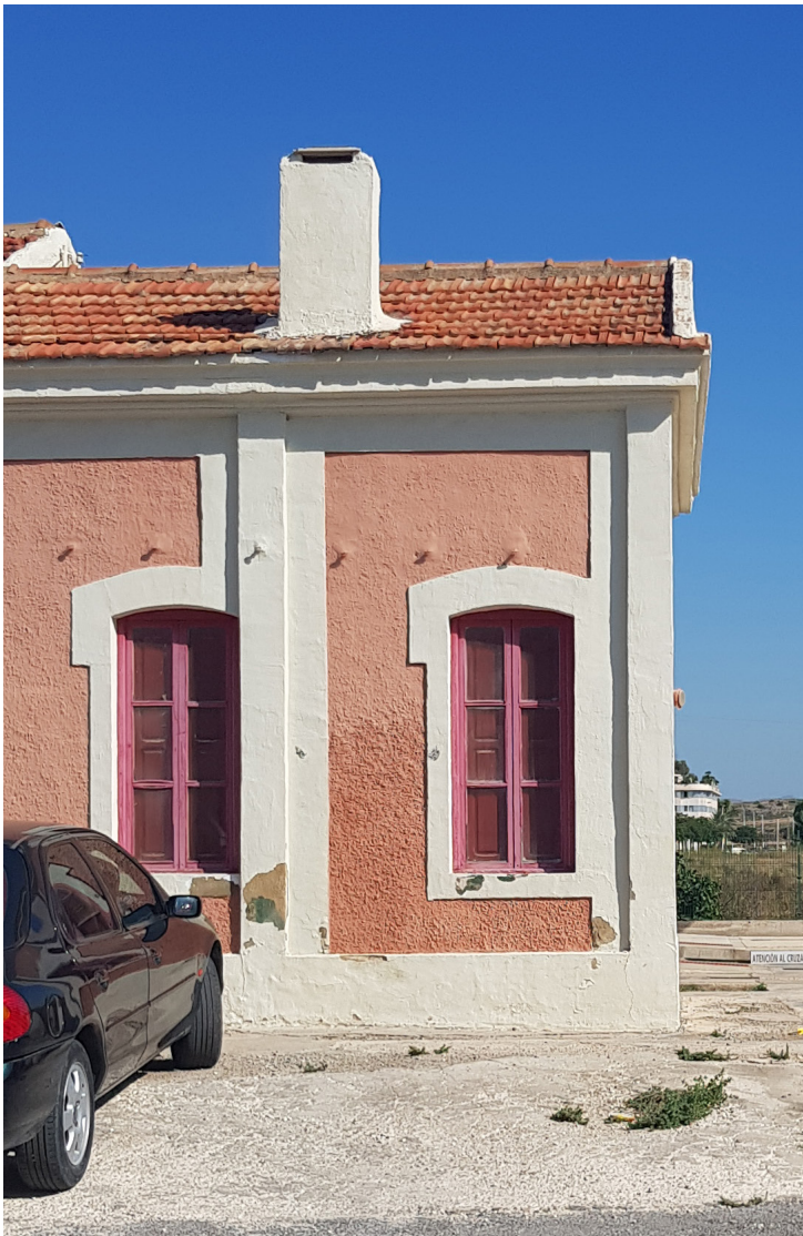
Desconchados en la estación de Torrellano. Foto de autor
