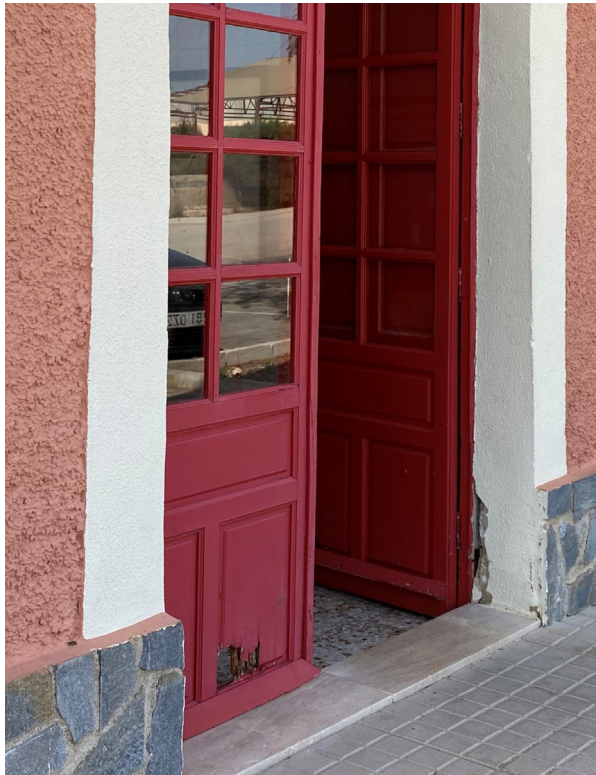
Patologías en la puerta principal de madera de Crevillente. Foto de autor
