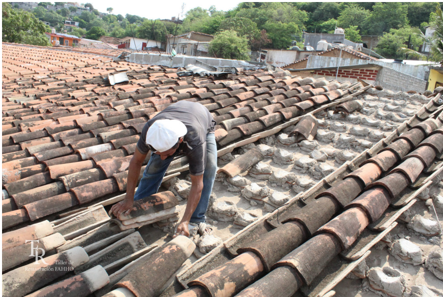
Ejemplo de reparación y sustitución de cubierta de tejas. Foto de taller de restauración FAHHO
