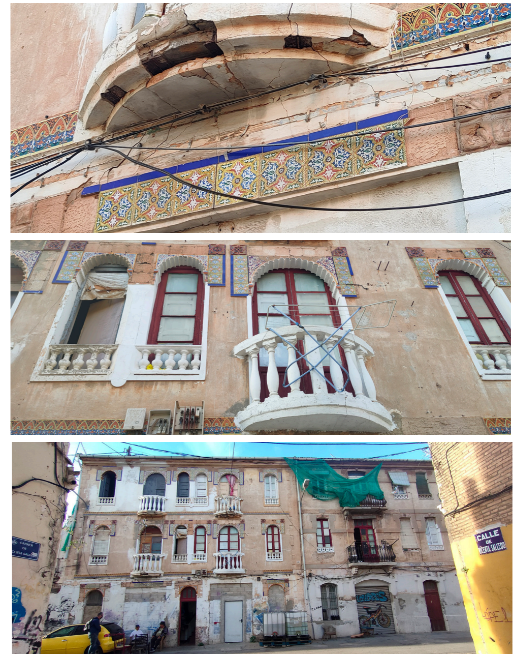
Fig.25. Imágenes del estado actual del edificio en calle Manuel Arnau 9. Fotografías realización propia
