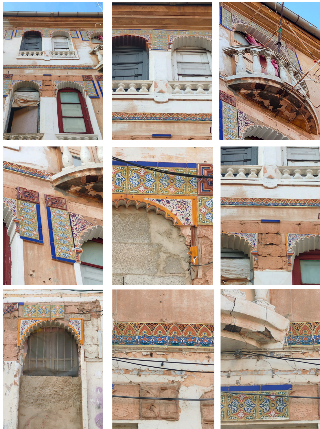
Fig.44. Imágenes detalle del estado de la fachada de la vivienda en calle Mnauel Arnau 9. Fotografías elaboración propia
