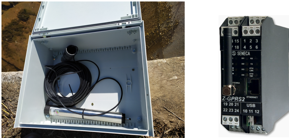
Figura 3: Sonda piezorresistiva y arqueta para instalación del dispositivo de transmisión de datos (datalogger).
