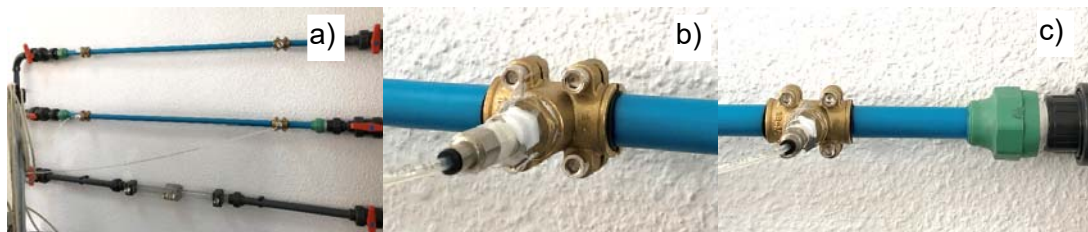
Figura 4: a) Tubería 1 (superior) y 2 (inferior), b) toma de conexión y c) uniones
