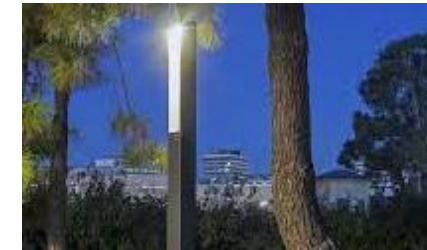
5. Luminaria urbana exterior
