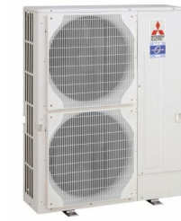
2.Unidad exterior de captación aire
