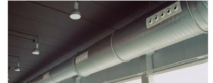
4. Canalización de ventilación con toberas
