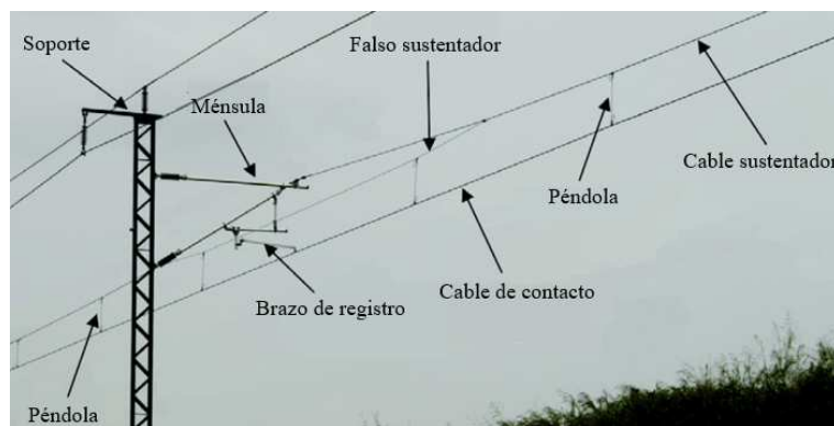
Figura 1: Imagen de una línea aérea de contacto.
