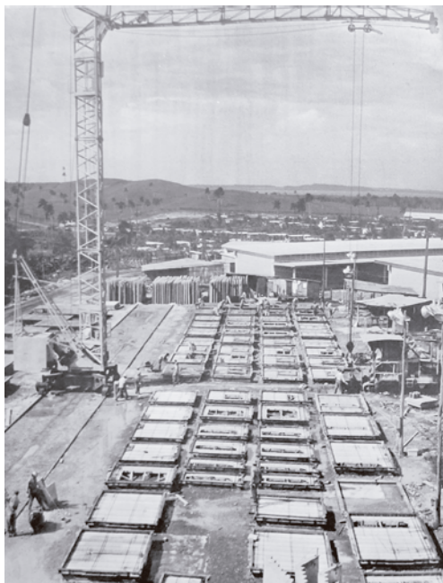
Figura 106. Planta de prefabricado a cielo abierto. Fuente: Segre, Roberto. La vivienda en Cuba en el siglo XX: República y Revolución . 1980. Editorial Concepto. 11 de agosto de 2021.
