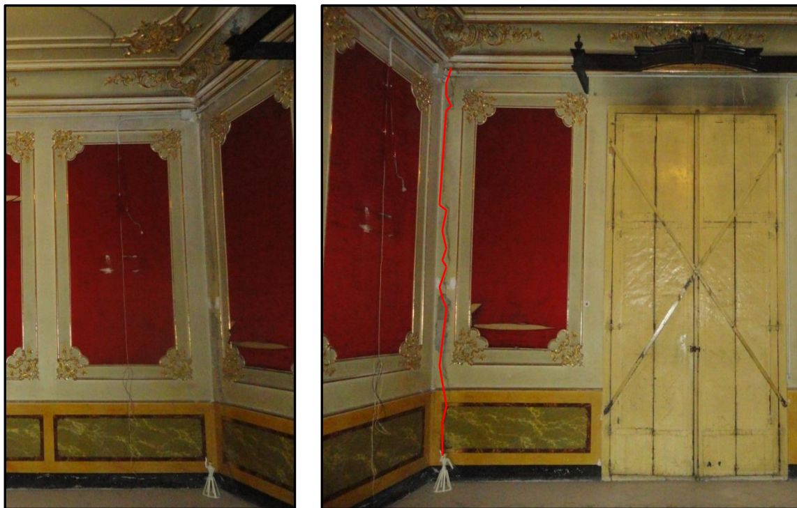
Figura 6. Fisuración en los muros de carga que conectan con la fachada Este.
