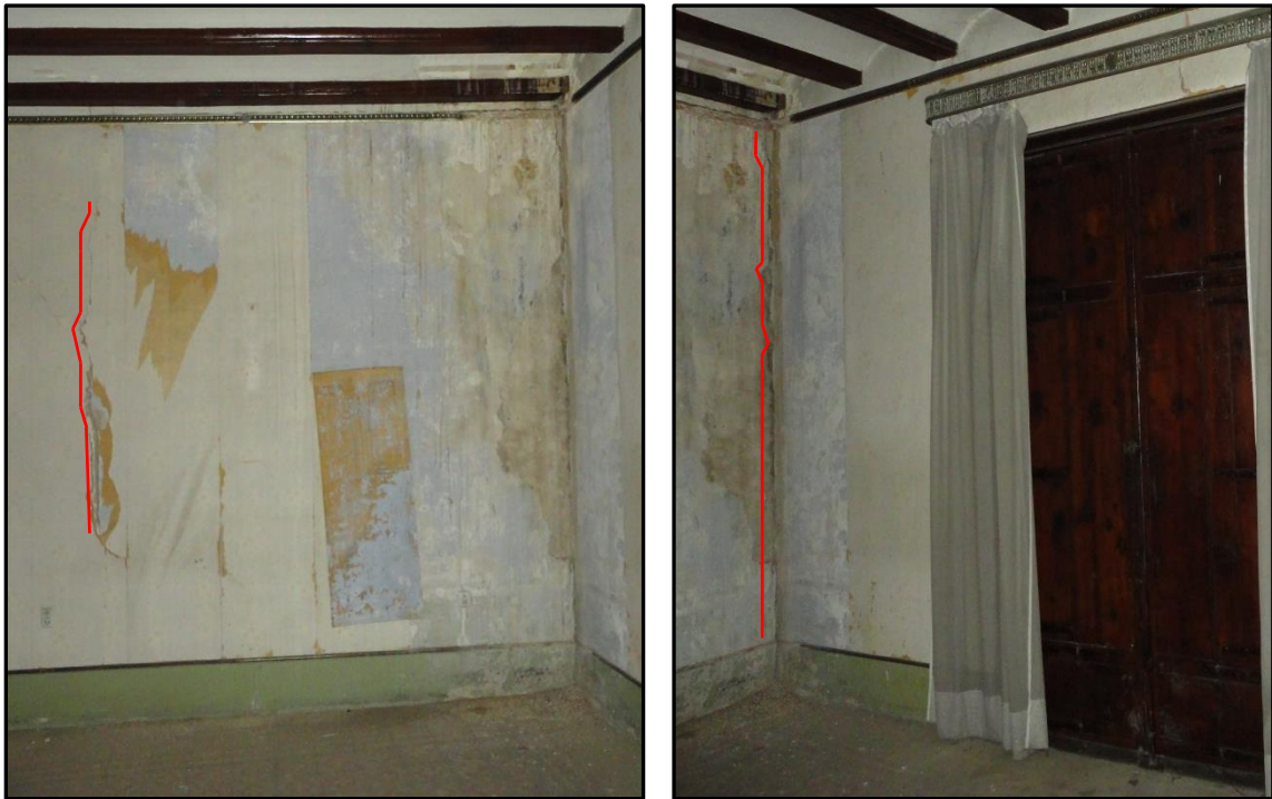
Figura 5. Fisuración en la fachada Este.
