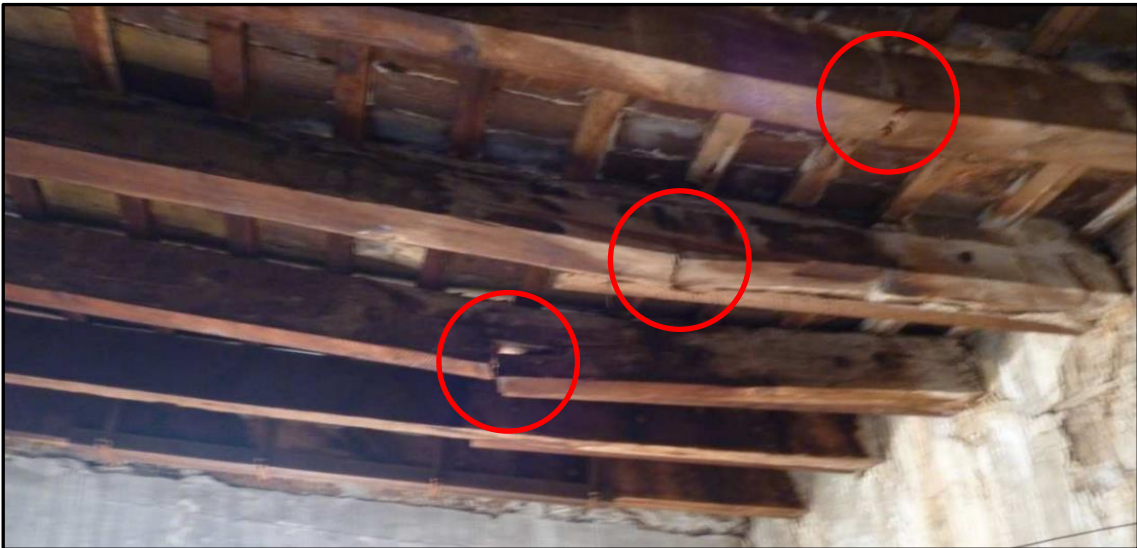
Figura 8. Estado de la cubierta de madera.
