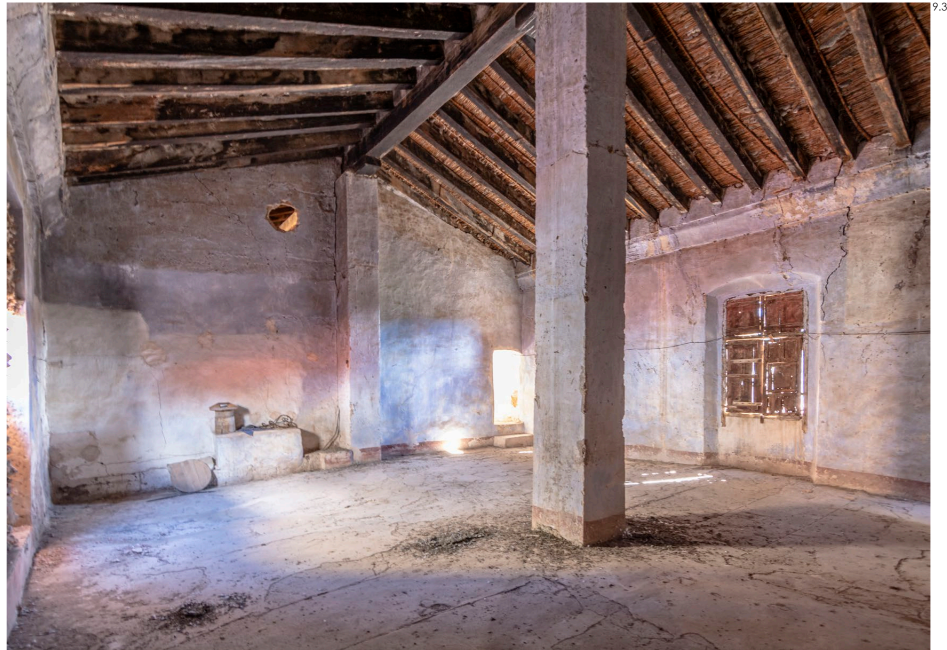
Imagen (9.3) Jácena de madera descansado sobre los pilares, sobre la jácena se disponen las viguetas de madera que se empotran en el muro.
