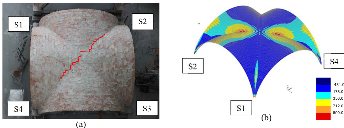
Figura 6. Grietas en la bóveda. (a). Cara superior, arco de elipse que une las bases de apoyo S2 y S4. (b)- Modelo numérico de elementos finitos, donde se observan las mayores tensiones principales de tracción, en KPa, para un asiento de 10 mm en el arco de elipse antes mencionado.
