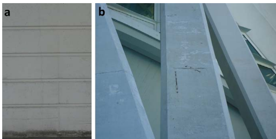
Figura 5: a) Fisuras por contracción térmica inicial en un muro; b) Corrosión en uno de los pilares
