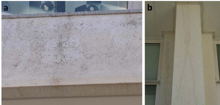
Figura 4: Coqueras o poros en superficies. a) Cornisa; b) Pilar
