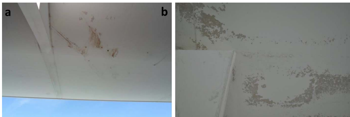
Figura 3: a) Fisuras y humedades debidas al paso del agua a través de una losa de forjado; b) Humedades y presencia de deposiciones de carbonato cálcico
