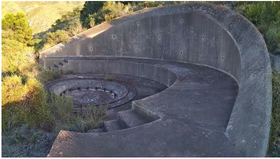
Figura 18: Estado actual de las barbetas, donde se puede ver la geometría semicircular de los muros de contención de hormigón. (Imagen propia)
