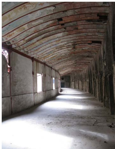
Fig. 118 Pérdida parcial de los frescos de los revoltones
