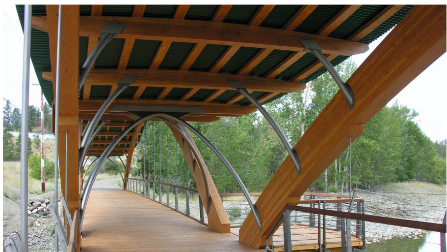
Imagen 1.14 Vista del puente con piezas curvadas de Glulam. - https://structurecraft.com/projects/princeton-bridge
