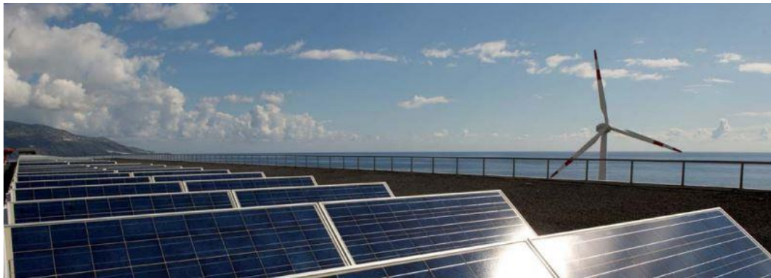
Imagen 1. Placas solares y aerogenerador instalados en el aeropuerto de La Palma
