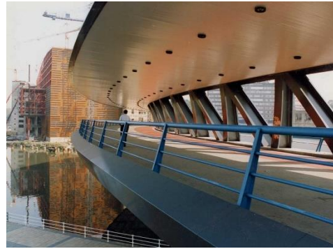
Imagen 19. Parte peatonal. Going Ingeniería Civil, Asociación de ingenieros de caminos, canales puertos
