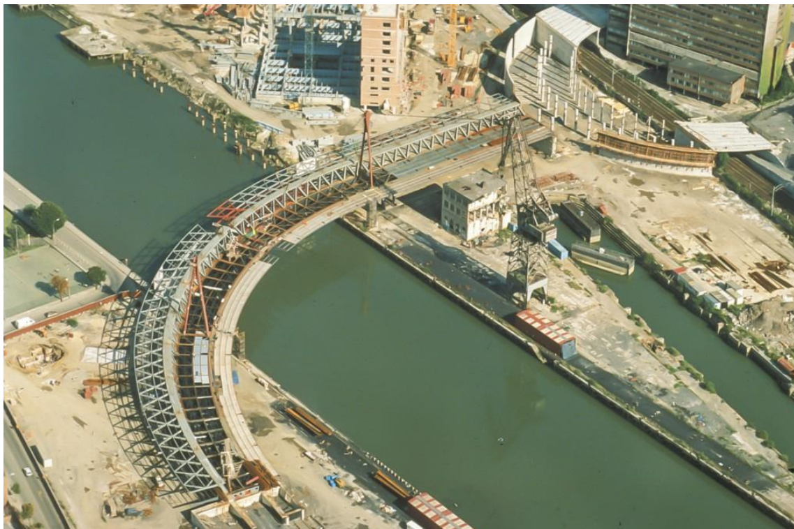
Imagen 16. Construcción del puente. Fuente: Oficina de Carlos Fernández Casado S. L. (CFCSL)
