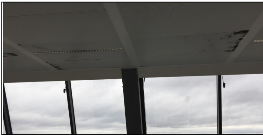
Image 5. Dégradations dans le faux plafond à cause des fuites au N8 double hauteur
