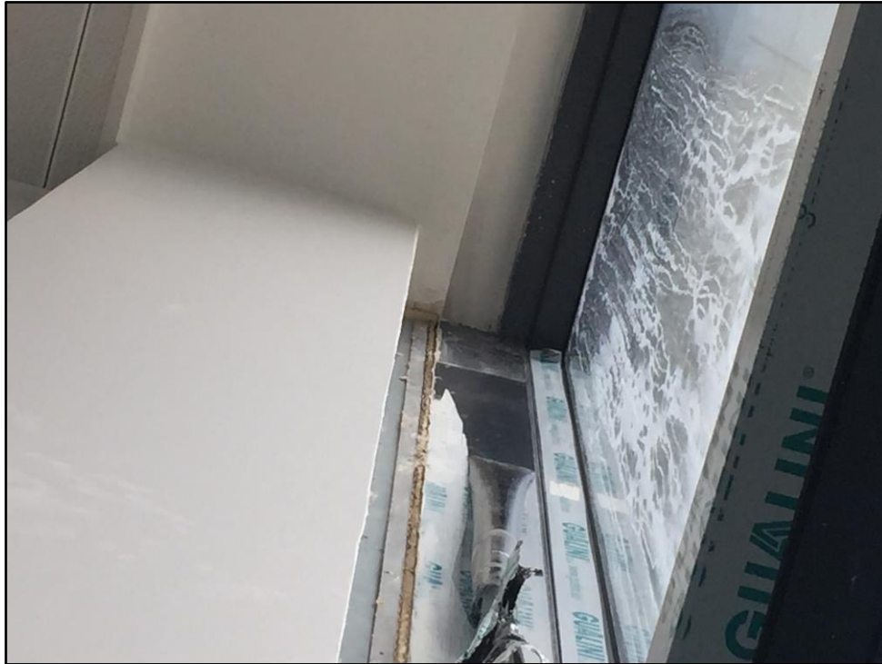
Image 10. Reprise de placo pourri à cause des fuites de façade
