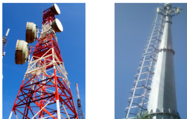
Imagen 51. Torre de celosía y torre tubular. Elaboración propia.
