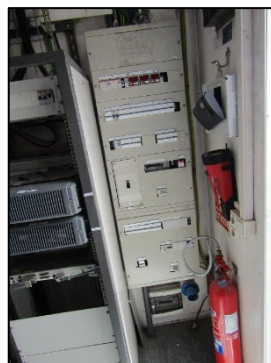
Imagen 21. Cuadro trifásico de interior. Elaboración propia.
