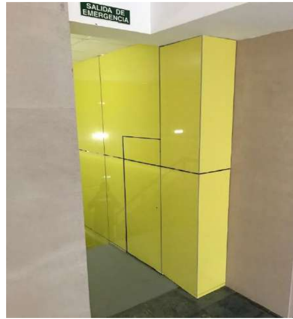
Fig. 78. Nueva escalera de emergencia revestida de gres.
