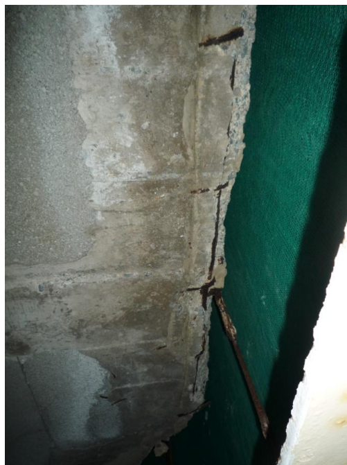
Foto nº 5 – Efectos de la corrosión en zona de fachada. Fuente: propia.
