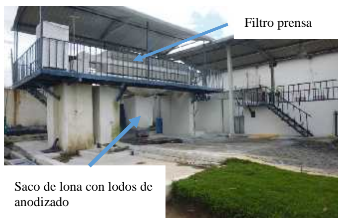
Figura 5.1. Filtro prensa y sacos de lona que almacenan lodos de anodizado de aluminio
