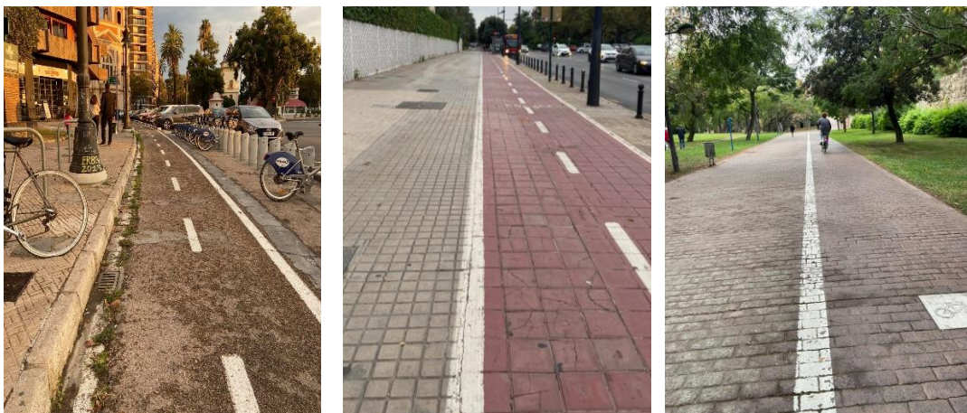
Figura 8-9. Ejemplos de pavimentos en estado POBRE. Fuente: Tomadas insitu
