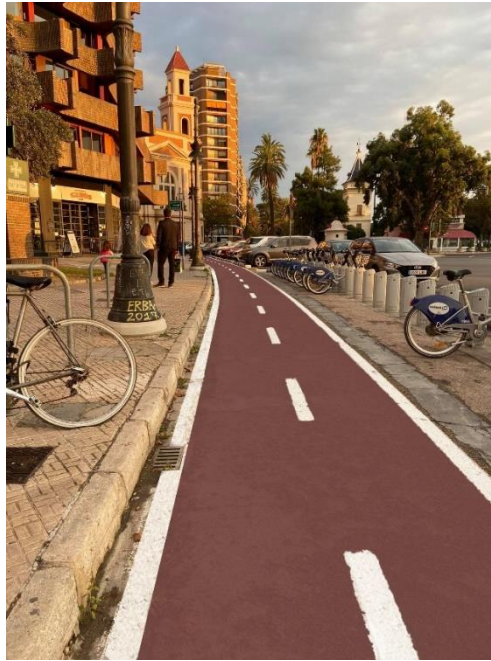
Figura 8-14. Fresado y reposición de capa de rodadura en la calle General Elio. Fuente: Elaboración propia
