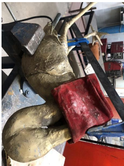
Fig. 69 Colocación del cuello y el torso empleando un gato para proceder a su soldadura.
