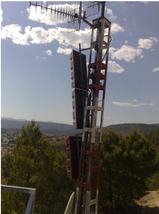
Figura 28: Paneles UHF y torreta
