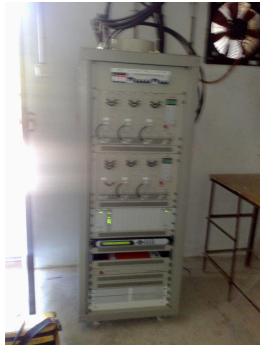
Figura 29: Equipos reemisores de TDT
