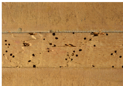
Figura 57. Detalle del ataque de insectos xilófagos en uno de los travesaños.
