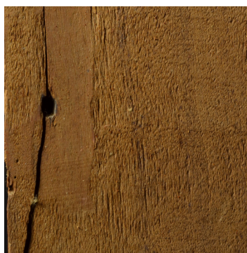
Figura 54, 55 y 56. Detalle de las fisuras y grietas.
