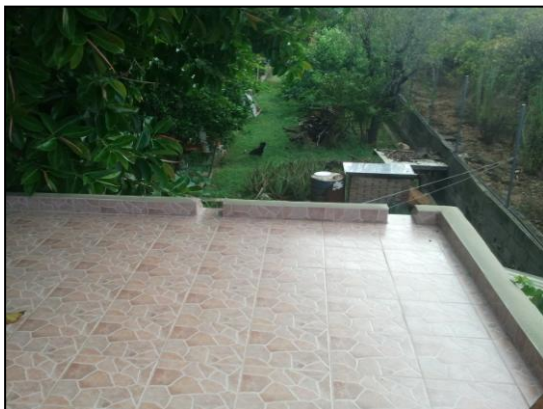
Foto 3: Tejado de parte de la casa que sirve para recolectar el agua de lluvia
