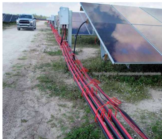
Figura (4.1) CAB en cableado de grouping
