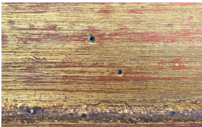
Figura 55. Detalle del marco atacado por xilófagos.
