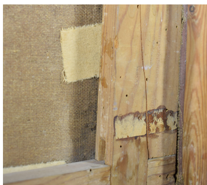
Figura 46. Detalle de los parches 5 y 6.
