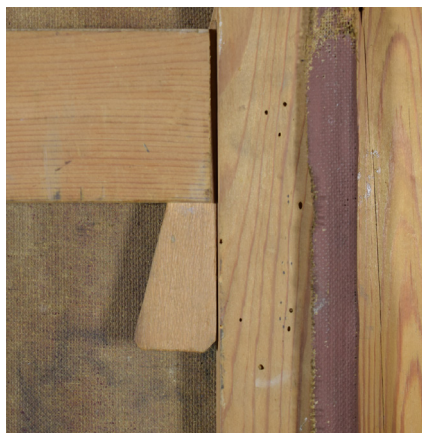
Figura 51. Detalle del bastidor atacado por xilófagos.
