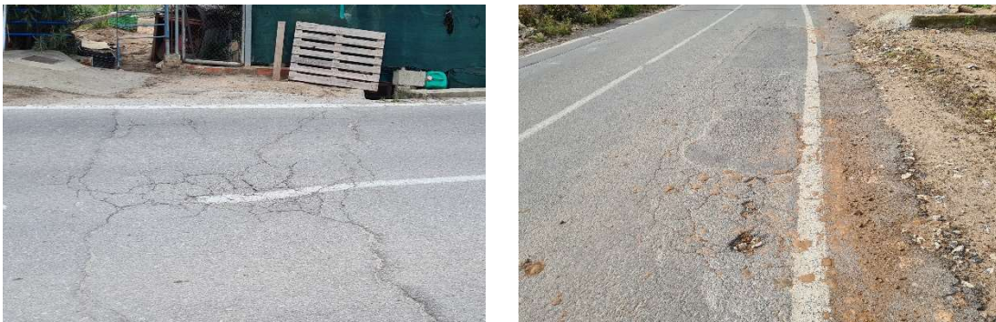
Imagen 60. Estado del firme
