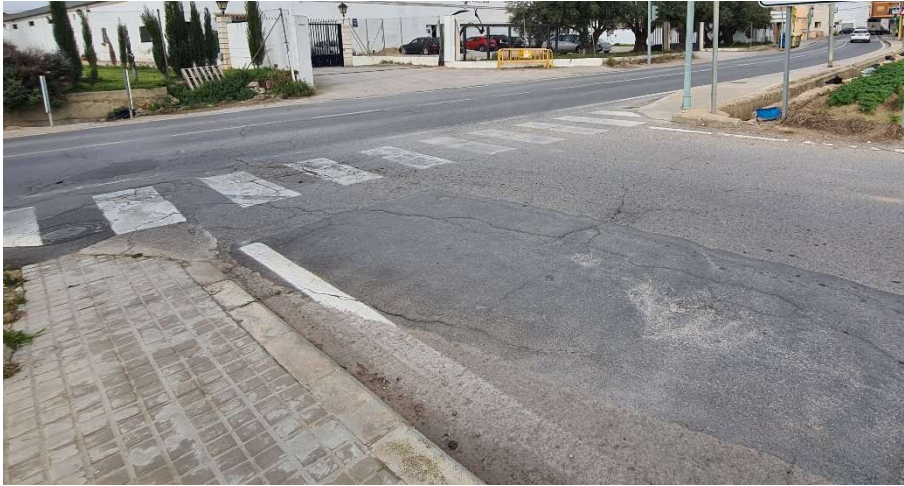
Imagen 59. Varias fisuras en interseccion con CV-315.
