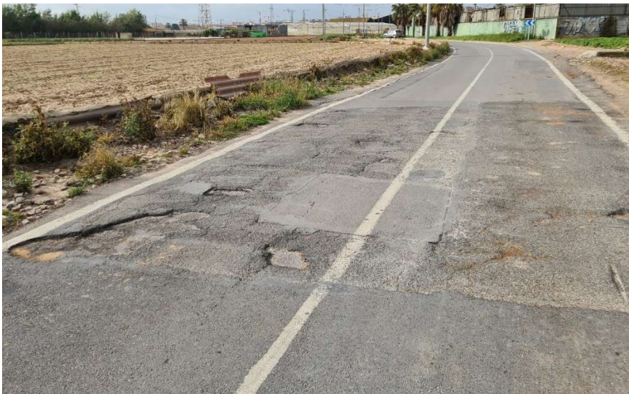
Imagen 58. Peladuras en el pavimtno.
