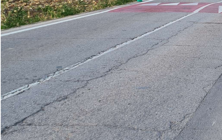
Imagen 57. Fisura longitudinal centra.
