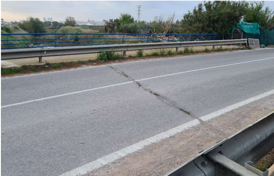
Imagen 61. Estado del firme
