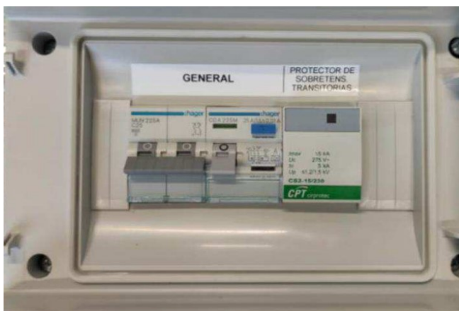
Figura 27: Caja para la parte de CA con elementos de protección instalados
