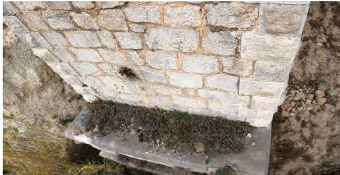
Figura 16. Daños en el estribo 2 (Fuente: información proporcionada por el tutor).
