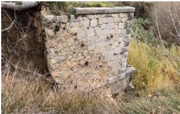
Figura 17. Daños en el estribo 2 (Fuente: información proporcionada por el tutor).
