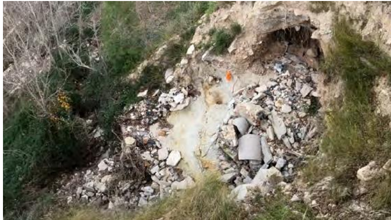
Figura 12. Daño por rotura de colector en el estribo 1 (Fuente: información proporcionada por el tutor).
