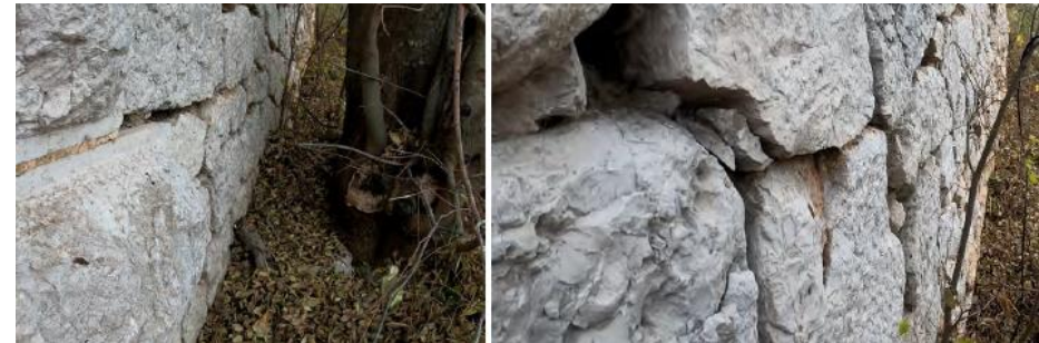
Figura 11. Daños en el estribo 1 (Fuente: información proporcionada por el tutor).
