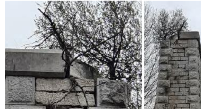
Figura 14. Daños en la coronación de la pila 2 (Fuente: información proporcionada por el tutor).
