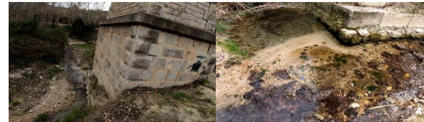
Figura 15. Socavación en la pila 2 (Fuente: información proporcionada por el tutor).
