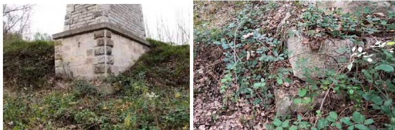
Figura 13. Daños en la pila 1 (Fuente: información proporcionada por el tutor).
