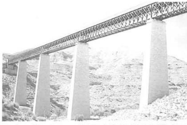
Ilustración 2. Celosía metálica de un puente recto de finales del siglo XIX. (Fuente: Evolución de los puentes en la historia reciente).
