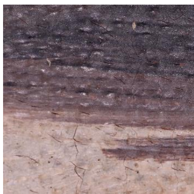
Fig.39 Pequeñas grietas en la superficie de la obra.
