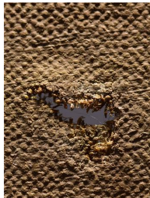
Fig.56 Detalle faltante dos, luz rasante.
