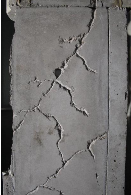
Figura 70: Detalle de las grietas en el prefabricado de hormigón. Foto del autor.
