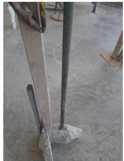
Figura 61: Colocación de la tubería y en gres en la arenisca. Foto del autor.
