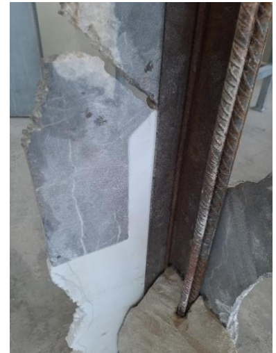
Figura 47: Detalle del perfil y varilla de hierro. Foto del autor.
