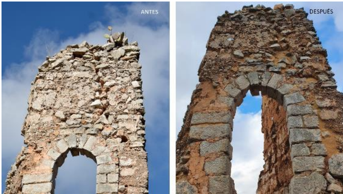
Se pueden observar los faltantes en el muro antes de la restauración (izqda.), entrada de agua y diversos microorganismos. Tras la restauración (drcha.) los faltantes quedan sellados por vertido de cal hidráulica (consolidación) y sellado con mortero hidráulico. Fuente: (izqda.) ZALBIDEA, 2021; (drcha.) BALLESTEROS, 2022.
