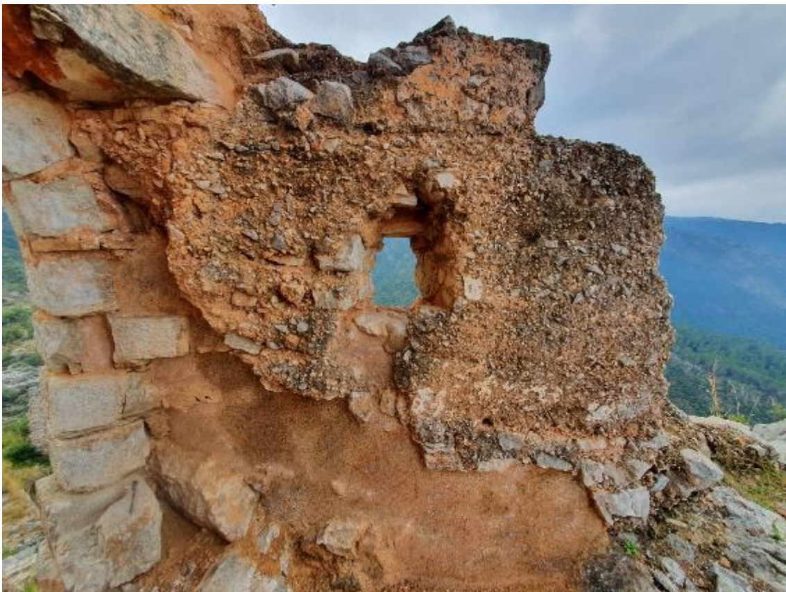
Figura. 36. Vista Sud. Puerta de medio punto. Imagen sup.: Antes de la restauración. La superficie del suelo, se observa un faltante de tamaño considerable. Fuente: ZALBIDEA, 2021 Imagen inf.: Después de la restauración. Sellado del faltante inferior. Fuente: BALLESTEROS, 2022.
