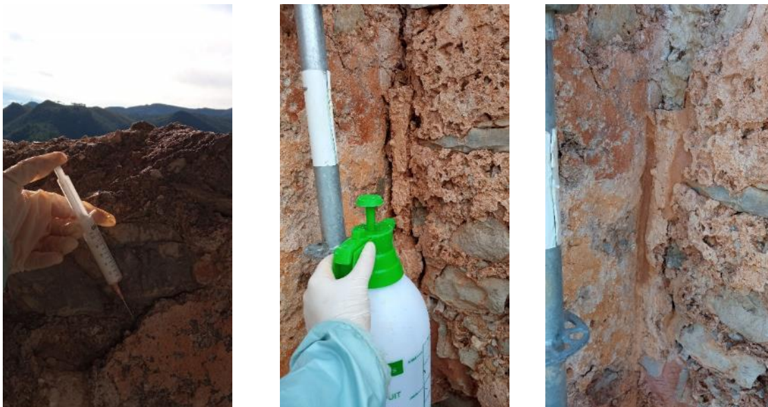
Figura. 33. De izqda. a drcha.: Inyección de EVA ART al 2% con agua desionizada. Consolidación de los estratos; Humectación previa de la zona a aplicar el mortero; Sellado de grietas con mortero hidráulico. Fuente: CASTELLET, 2021.
