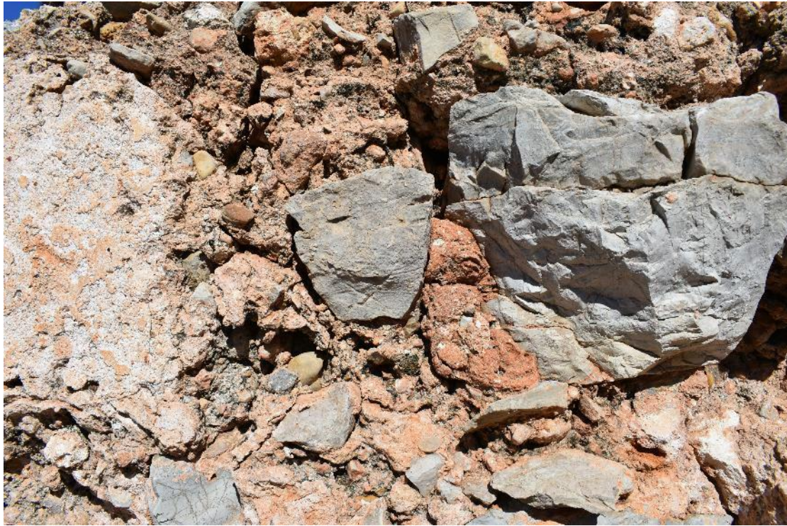
Figura. 29. Se aprecian numerosos faltantes interconectados y pérdida del revestimiento. Material en disgregación. Fuente: ZALBIDEA, 2021.
