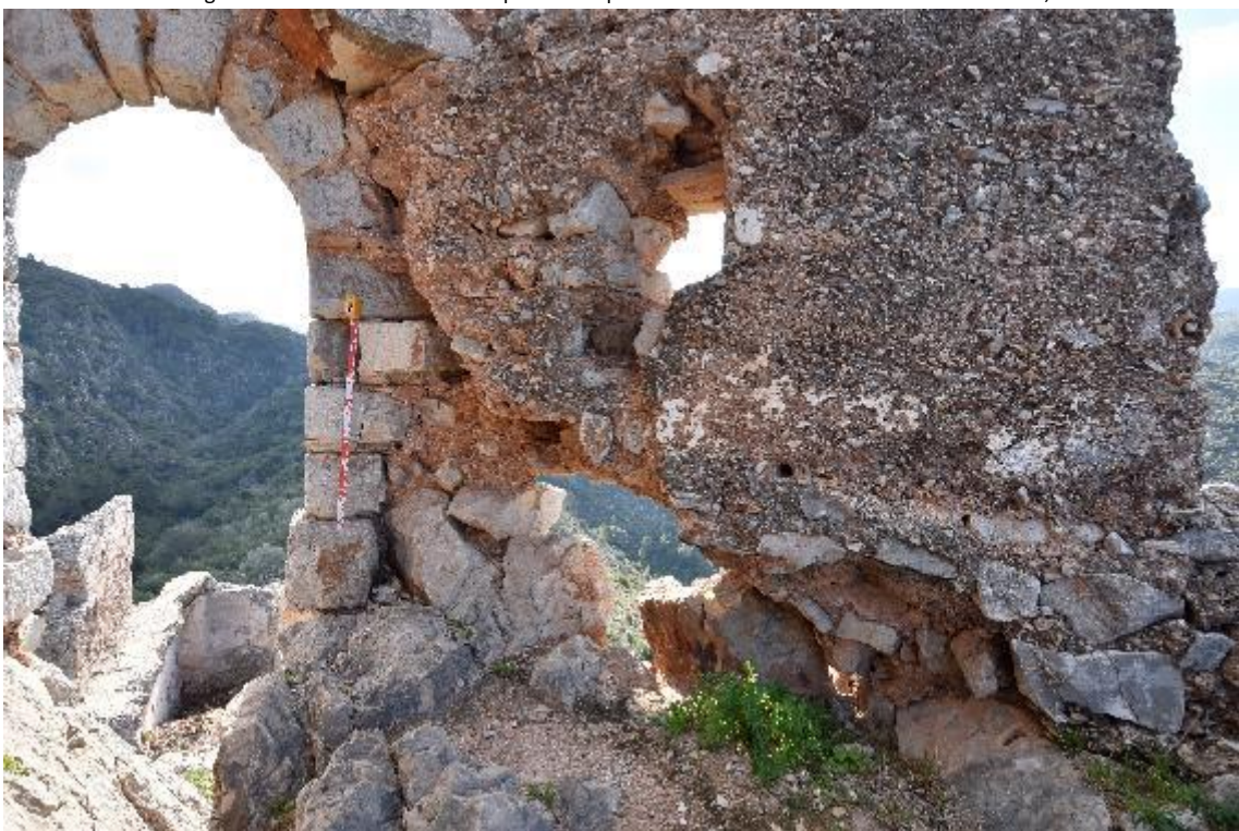
Torre de l’Homenatge. Vista este-sud. Puerta de medio punto. Antes de la restauración. La superficie del suelo, se observa un faltante de tamaño considerable. Fuente: ZALBIDEA, 2021.
