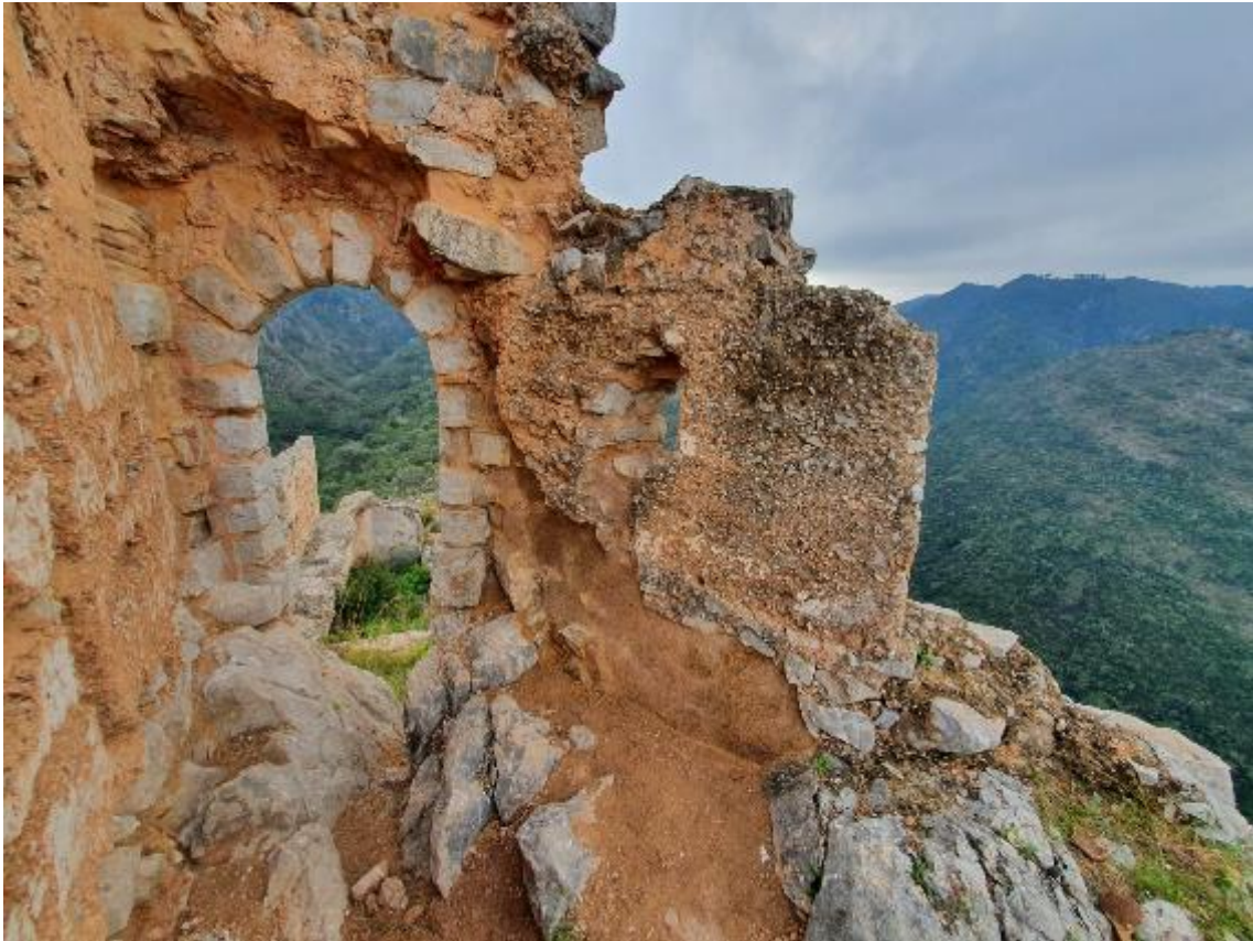
Torre de l’Homenatge. Vista este. Puerta de medio punto. Después de la restauración. Fuente: BALLESTEROS, 2022.
