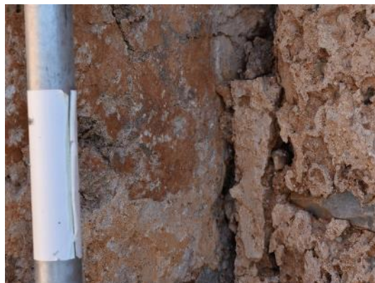
Figura. 20. Numerosas faltantes y oquedades en muro este interno de la Torre. Zonas donde se deposita el agua de lluvia. Fuente: ZALBIDEA, 2021.
