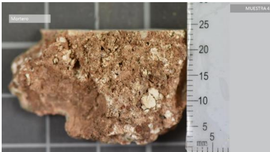
Muestra 4. Fotografía macro del reverso de uno de los fragmentos de 2,5 cm de alto. Mortero de tonalidad rojiza debido a las arcillas del terreno y en el que se aprecian caliches y minicaliches. Fuente: CASTELLET, 2021.
