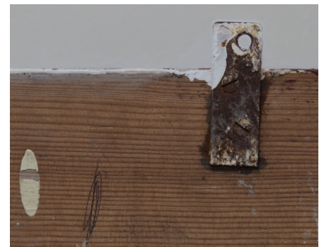
Figura 50.- Sistema de anclaje a la pared, marca de bolígrafo y mancha de pintura
