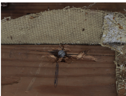
Figura 42.- Detalle craqueladura derivada de un golpe, agravada por los hongos. Anverso y reverso
