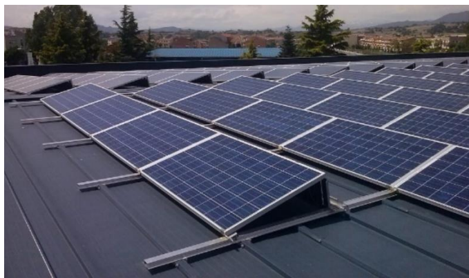
Imagen 9. Posible distribución de las placas solares.
