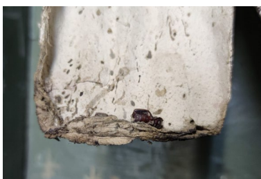
Fig. 32 Degradación del cartón-piedra
