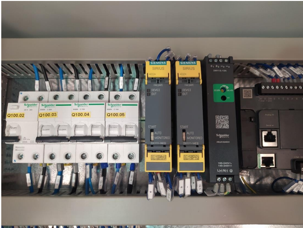
Img.10 Protecciones, relés de seguridad y fuente de alimentación
