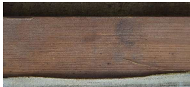
Figura 63 Detalle de la suciedad del bastidor
