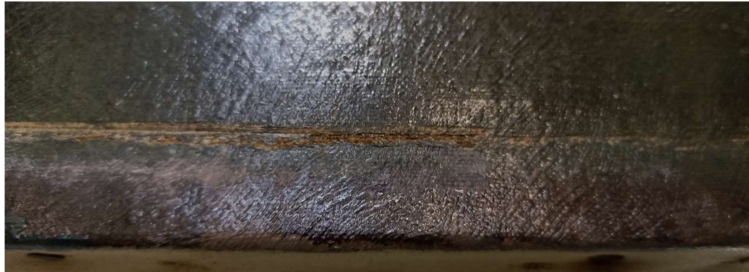
Figura 62 Detalle de pérdida de película pictórica e imprimación
