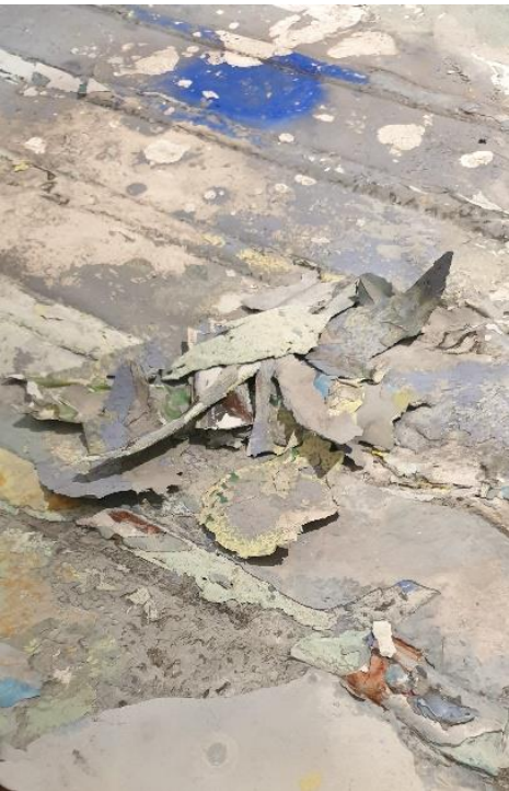
Fig.32. Fragmentos de residuos y distintas capas de pintura recuperados
