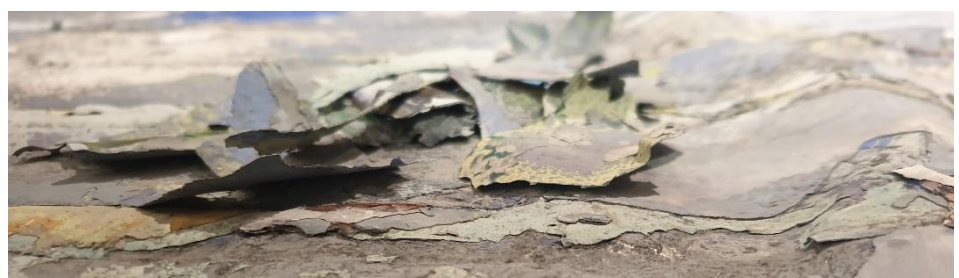
Fig.33. Fragmentos de residuos y distintas capas de pintura recuperados
