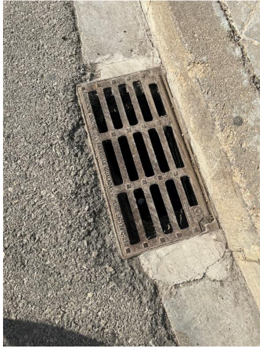
Figura 16: Ejemplo de servicio. Alcantarilla
