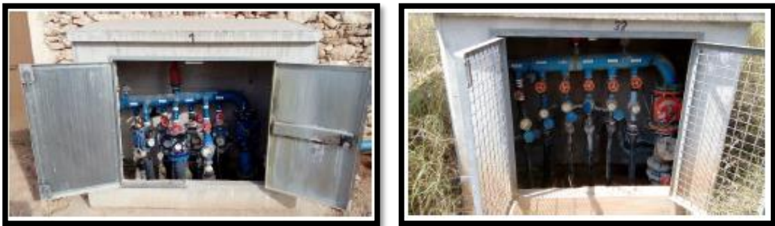
Figura 17: Hidrantes multiusuario de diferentes redes de distribución.
