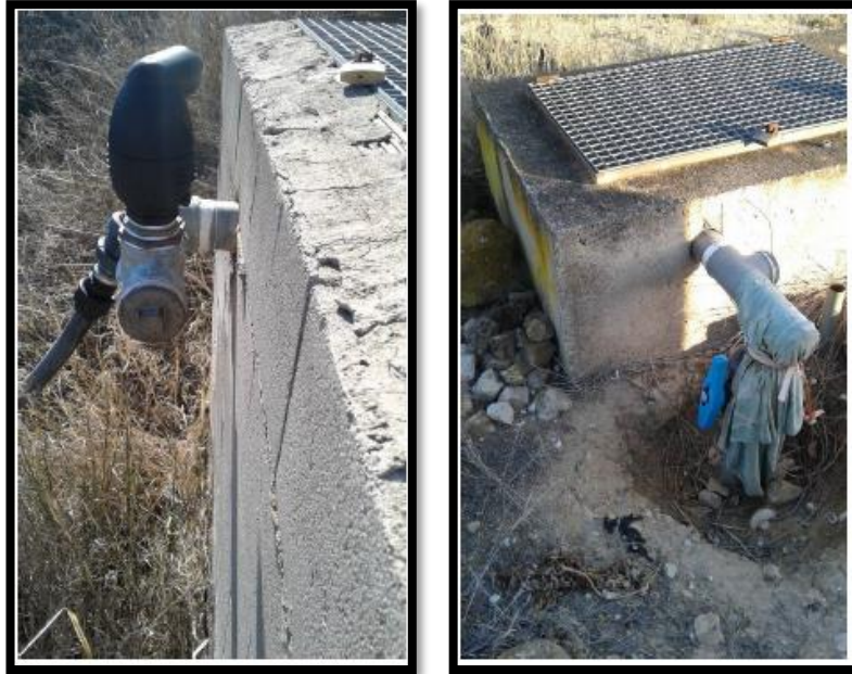
Figura 10: Detalle de distintas arquetas sin normalización de valvulería.
