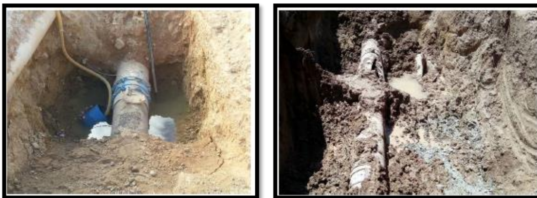
Figura 7: Detalle de roturas y reparaciones en conducción de fibrocemento.
