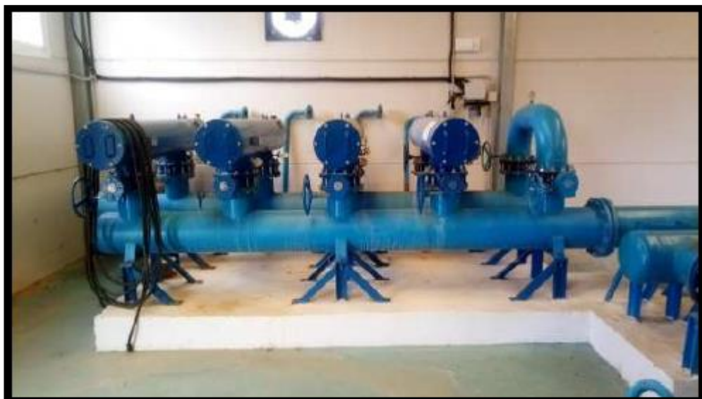
Figura 3: Estación de filtrado en Bombeo Oliveral.
