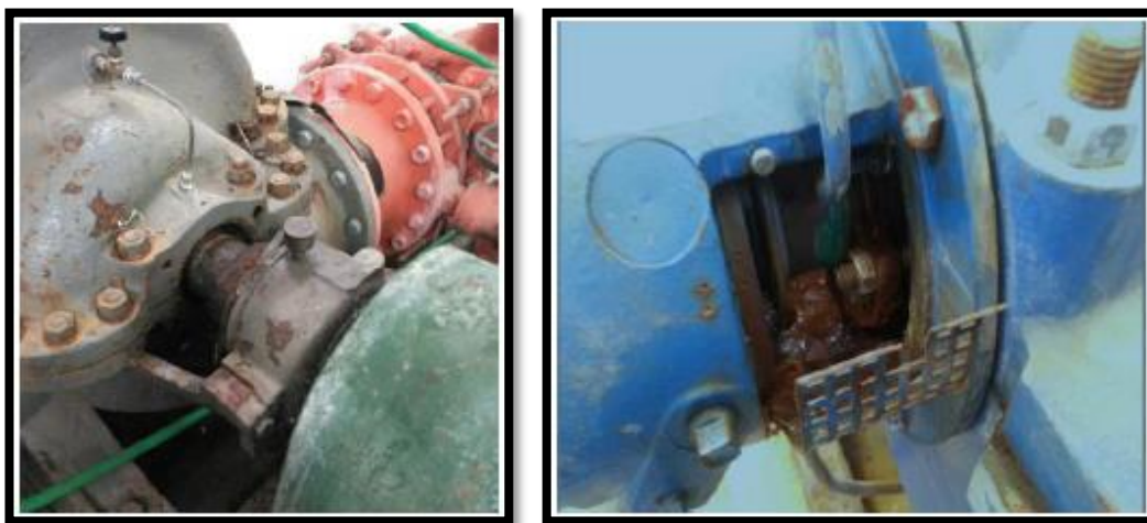
Figura 19: Detalle del estado de los equipos de bombeo.
