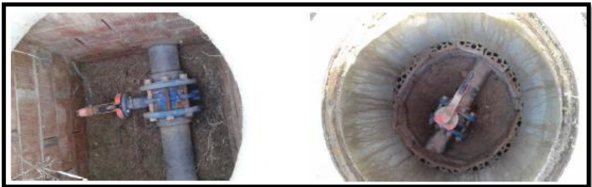
Figura 13: Detalle válvulas de mariposa con palanca.
