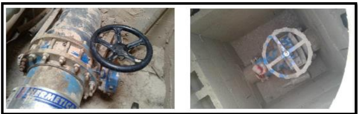
Figura 14: Detalle de válvulas de corte sin anclajes.
