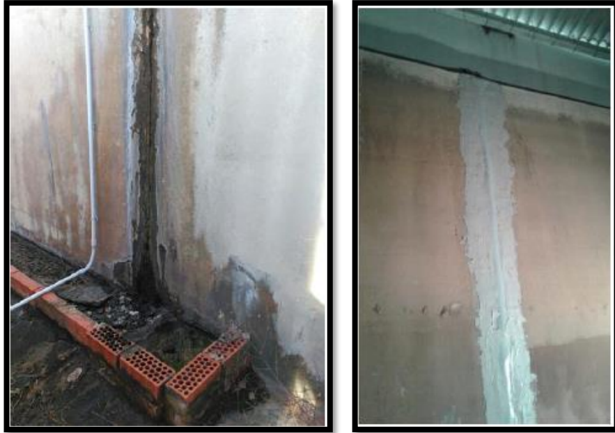
Figura 5: Fugas en el depósito de hormigón.
