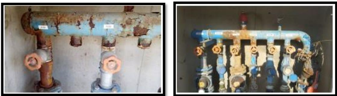
Figura 18: Colectores de hidrantes multiusuario en avanzado estado de deterioro.
