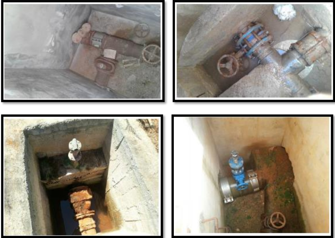
Figura 8: Detalle de valvulería en mal estado en Red Iryda.
